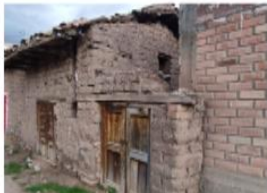
Vivienda en precarias condiciones basada en la construcción vernácula.
