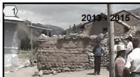
Imagen se puede observar la vivienda construida de adobe con piedras con techos a dos aguas puerta de madera se ve deteriorado.
