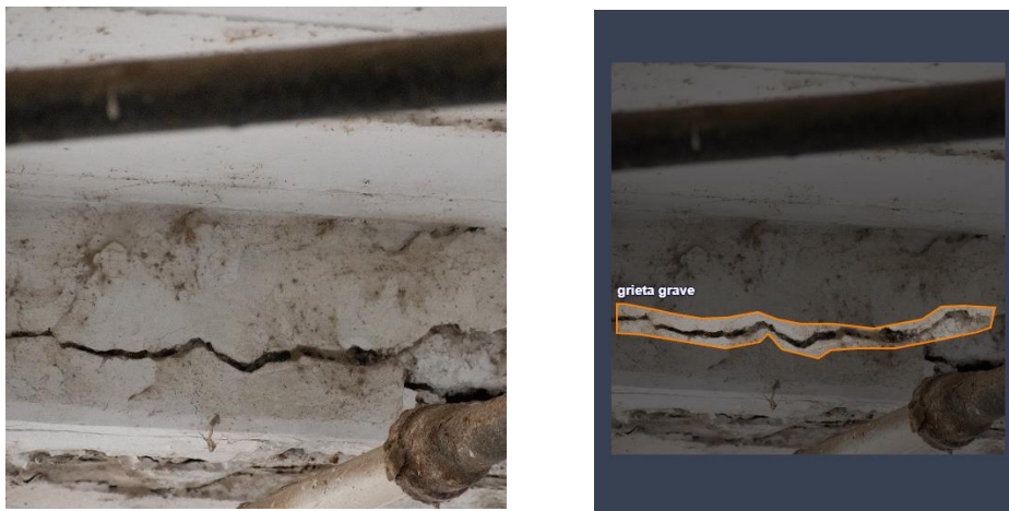
Figura 70. Identificación de grieta grave
