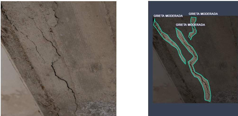
Figura 64. Identificación de grieta moderada
