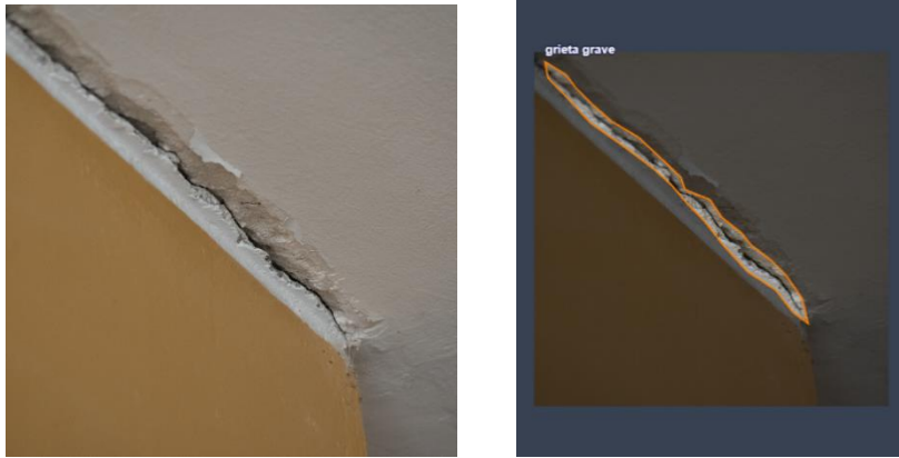
Figura 58. Identificación de grieta grave
