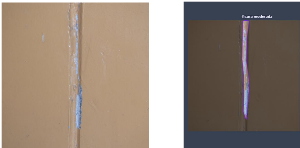
Figura 27. Identificación de Fisura moderada
