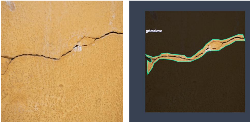
Figura 42. Identificación de grieta leve
