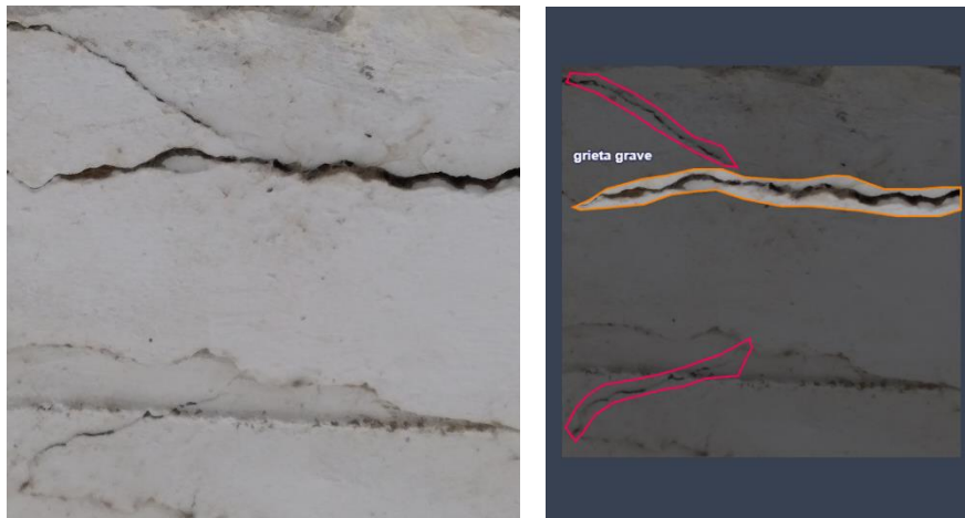
Figura 74. Identificación de grieta grave
