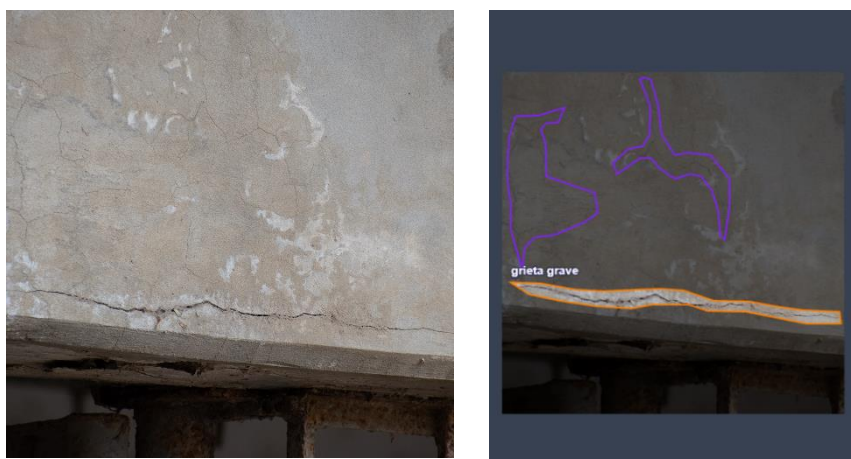
Figura 71. Identificación de grieta grave
