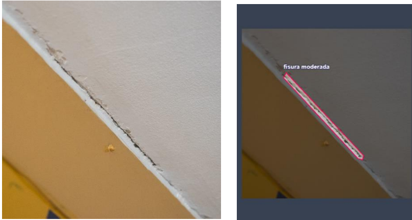
Figura 20. Identificación de Fisura moderada
