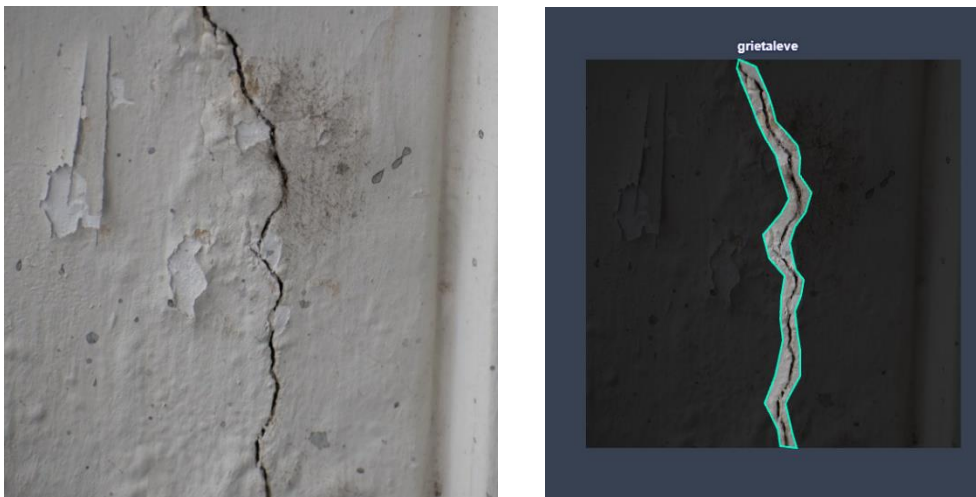
Figura 43. Identificación de grieta leve
