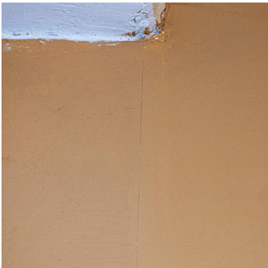
Figura 19. Identificación de Fisura leve
