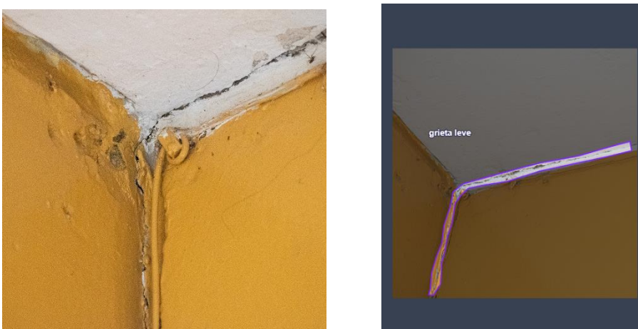
Figura 47. Identificación de grieta leve
