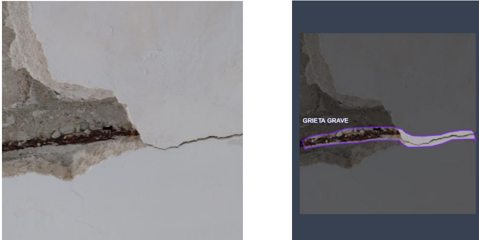
Figura 68. Identificación de grieta grave
