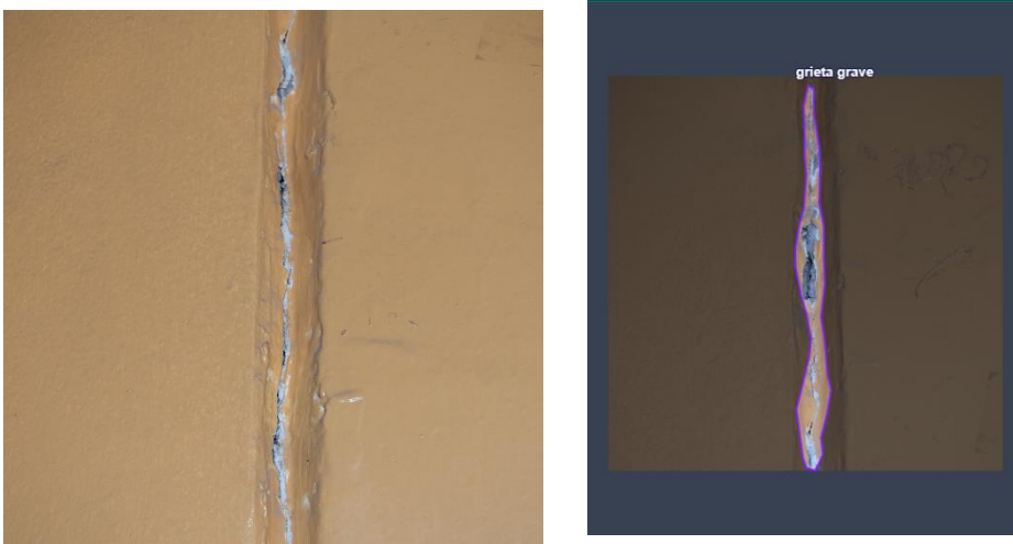
Figura 61. Identificación de grieta grave
