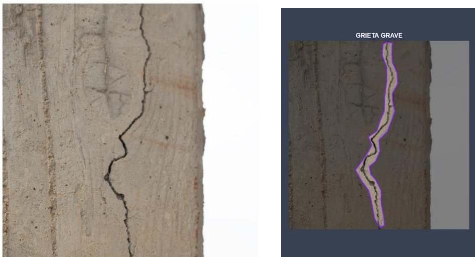
Figura 65. Identificación de grieta grave
