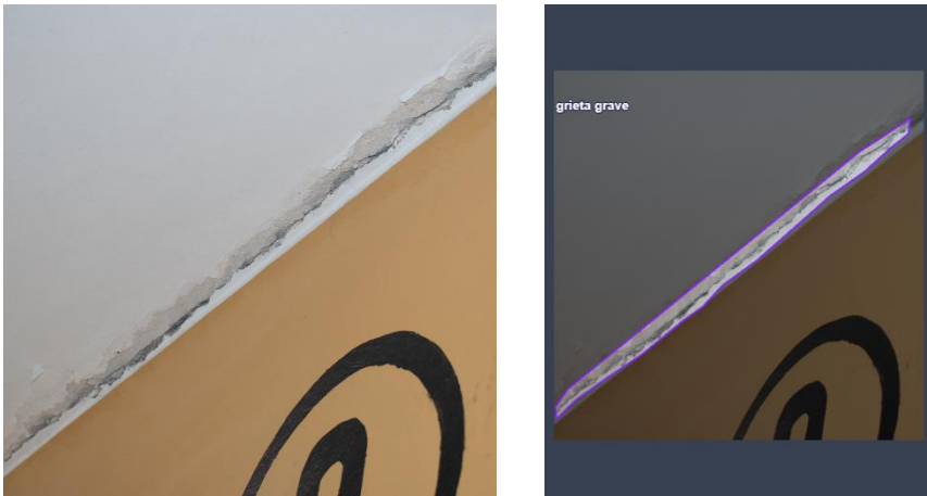
Figura 60. Identificación de grieta grave
