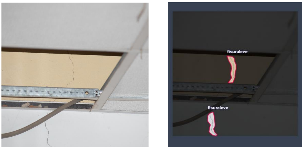
Figura 9. Identificación de Fisura leve
