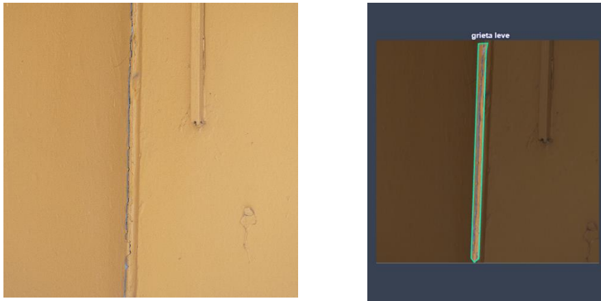
Figura 50. Identificación de grieta leve
