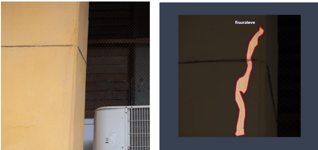
Figura 3. Identificación de Fisura leve
