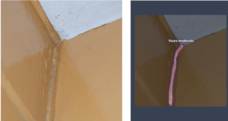
Figura 32. Identificación de Fisura moderada
