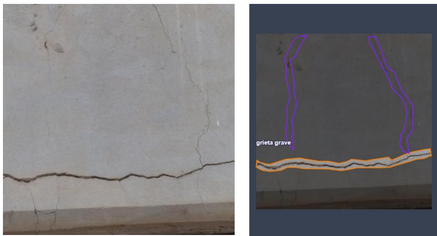
Figura 75. Identificación de grieta grave
