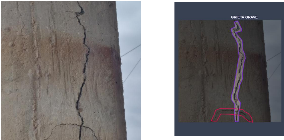
Figura 66. Identificación de grieta grave
