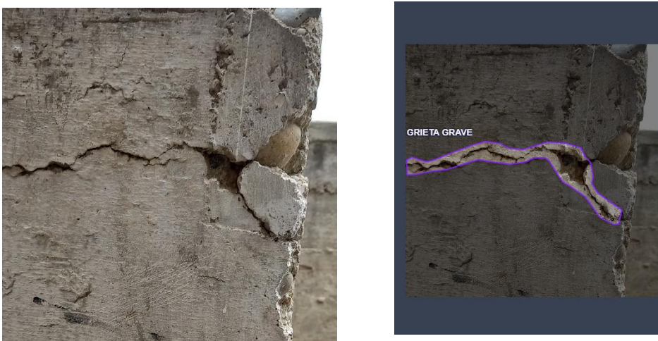
Figura 67. Identificación de grieta grave
