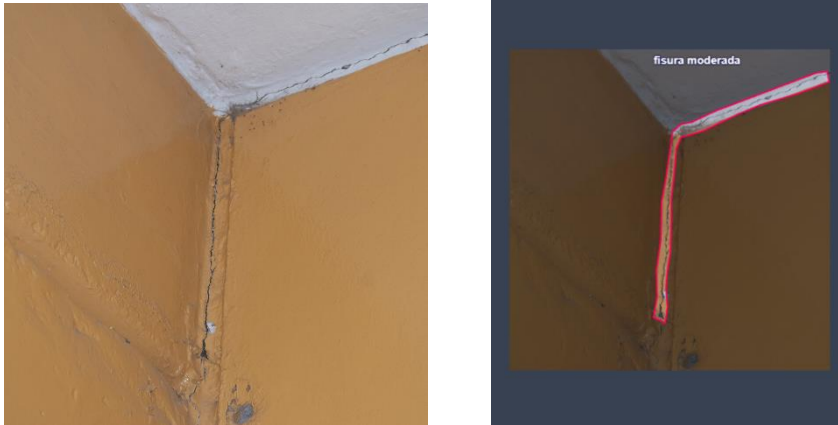
Figura 30. Identificación de Fisura moderada
