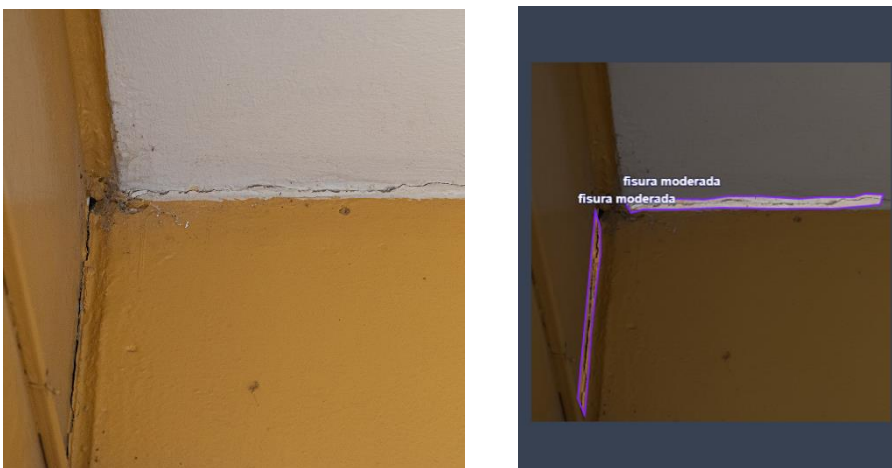
Figura 23. Identificación de Fisura moderada
