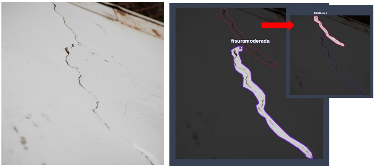
Figura 6. Identificación de Fisura leve y moderada
