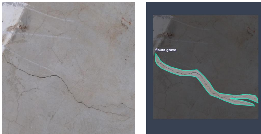
Figura 39. Identificación de Fisura grave
