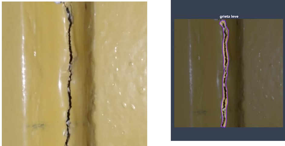
Figura 48. Identificación de grieta leve
