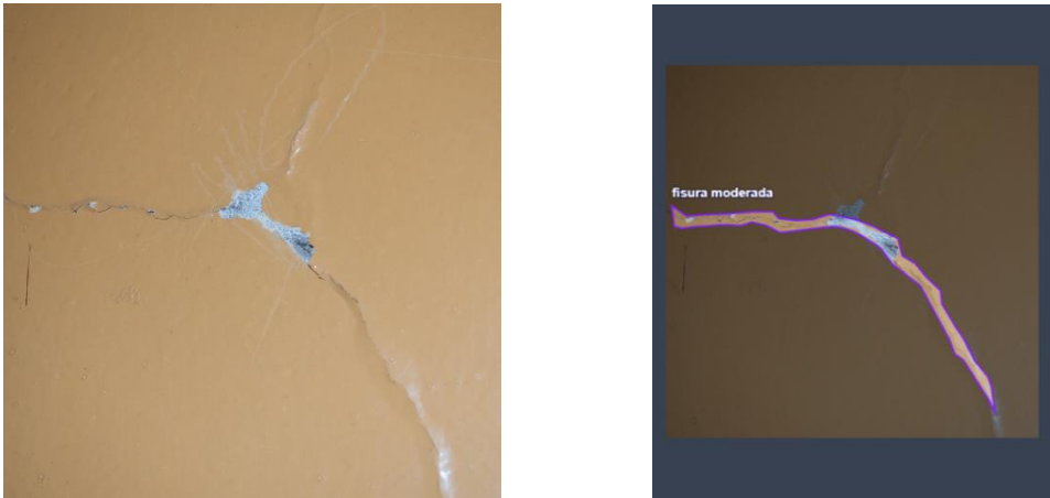
Figura 28. Identificación de Fisura moderada
