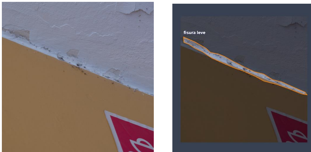
Figura 31. Identificación de Fisura leve
