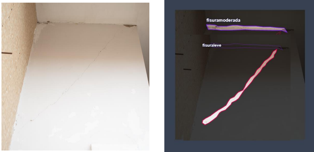
Figura 5. Identificación de Fisura leve y moderada
