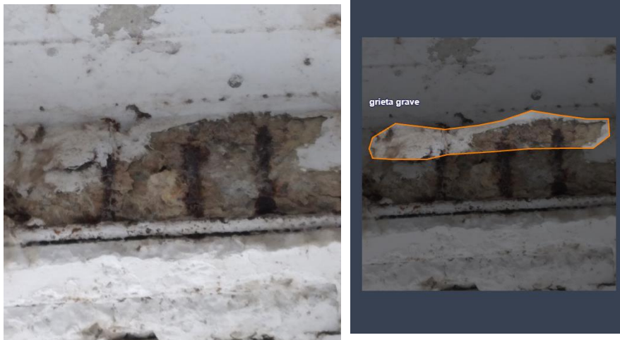
Figura 72. Identificación de grieta grave
