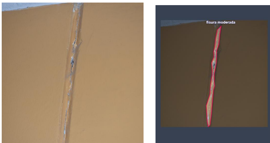
Figura 29. Identificación de Fisura moderada
