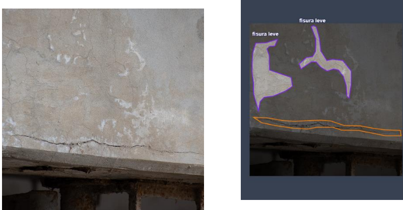
Figura 36. Identificación de Fisura leve
