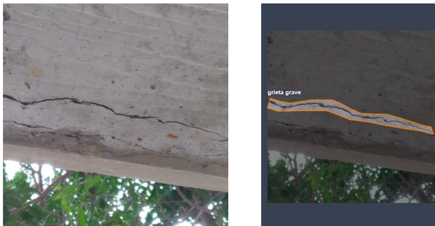
Figura 73. Identificación de grieta grave
