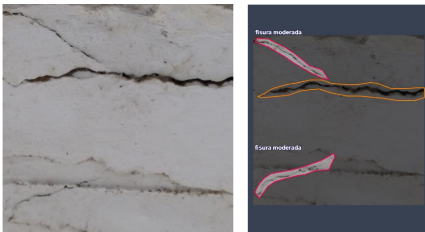
Figura 37. Identificación de Fisura moderada
