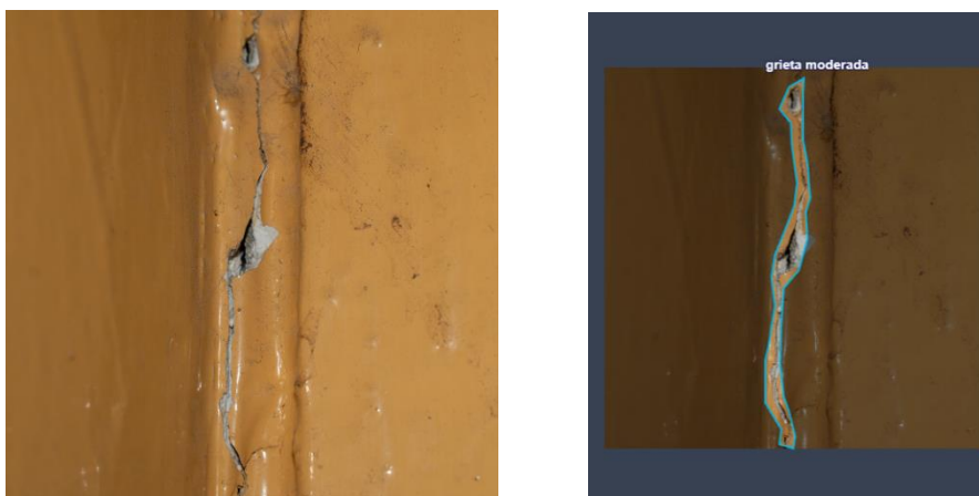
Figura 53. Identificación de grieta moderada
