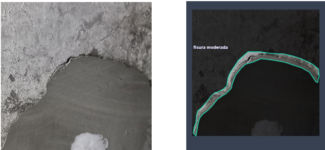
Figura 13. Identificación de Fisura moderada
