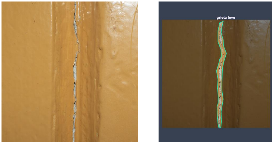
Figura 55. Identificación de grieta leve
