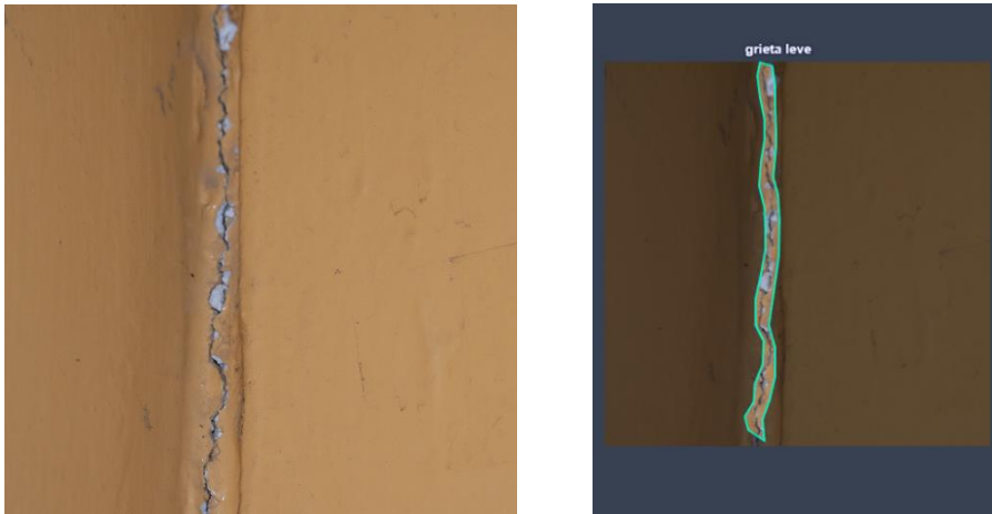
Figura 54. Identificación de grieta leve
