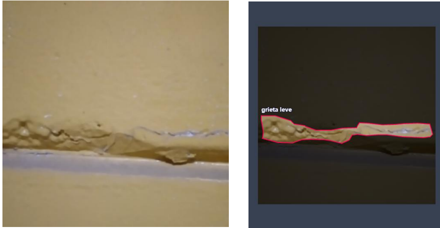
Figura 44. Identificación de grieta leve
