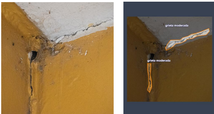
Figura 49. Identificación de grieta moderada
