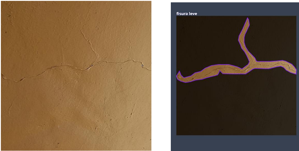
Figura 12. Identificación de Fisura leve
