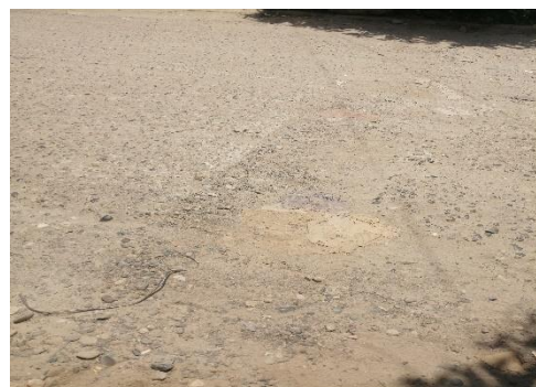
Figura 22. Losa de concreto deteriorada.
