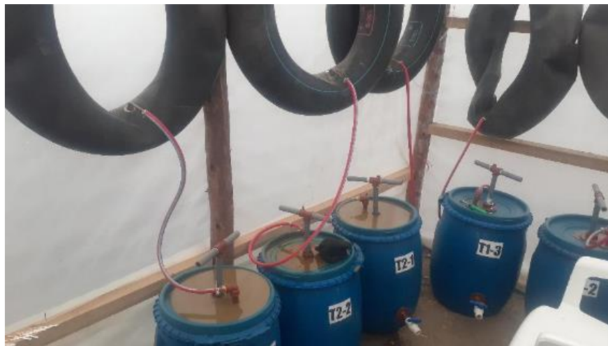
Foto N° 21: Excesiva acumulación de biogás en el gasómetro que causó reflujó de los biodigestores por el espacio del agitador
