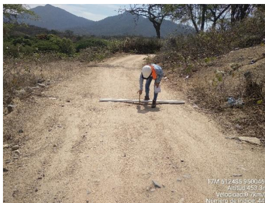
Figura 22: Deformaciones en el Km 2+000 a 2+500 (elaboración propia)
