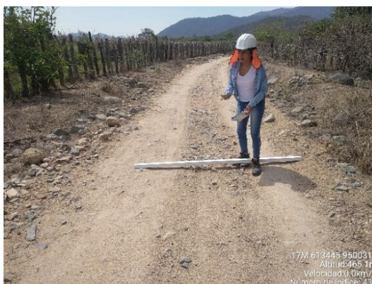
Figura 24: Erosiones en el Km 3+000 a 3+500 (elaboración propia)
