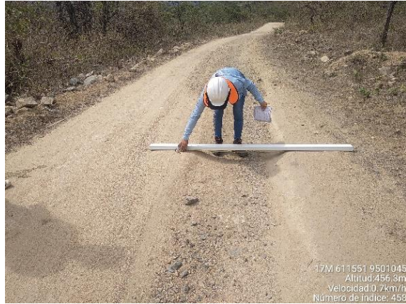
Figura 19: Erosión de gravedad 3 en el Km 0+810 (elaboración propia)
