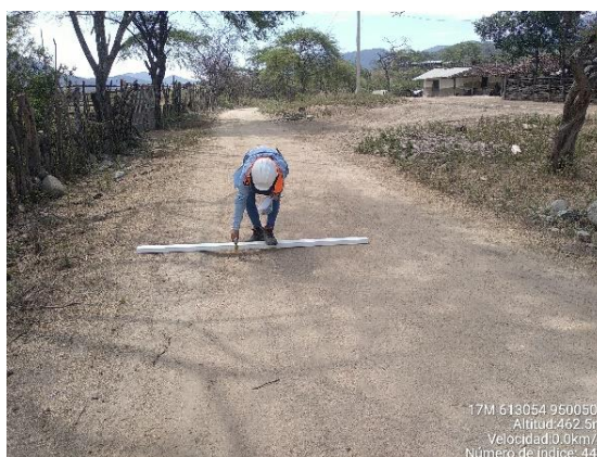
Figura 23: Deformaciones en el Km 2+500 a 3+000 (elaboración propia)
