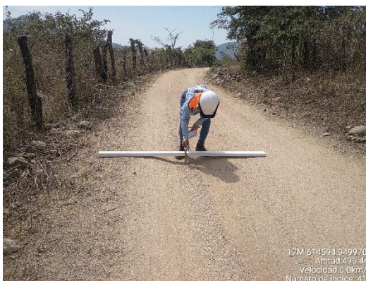
Figura 28: Deformaciones en el Km 5+000 a 5+500 (elaboración propia)
