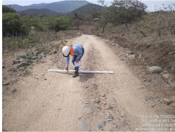
Figura 25: Erosiones en el Km 3+500 a 4+000 (elaboración propia)
