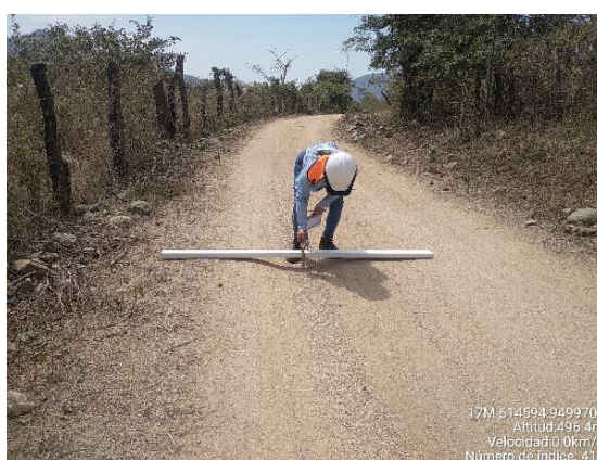
Figura 27: Deformaciones en el Km 5+000 a 5+500 (elaboración propia)
