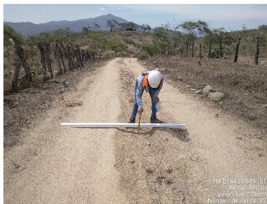
Figura 26: Erosiones en el Km 4+000 a 4+500 (elaboración propia)
