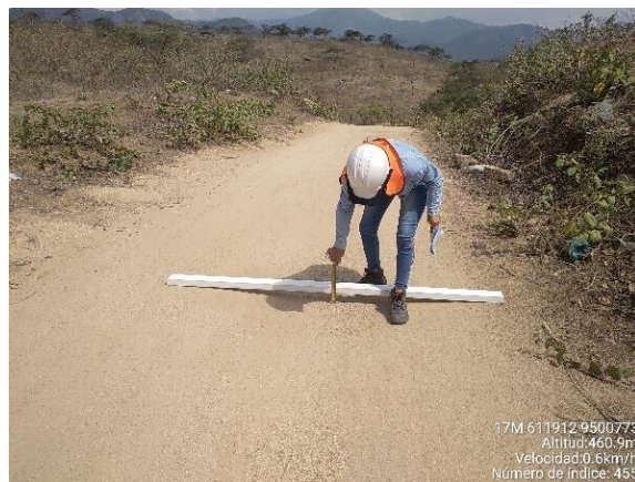
Figura 20: Deformación de gravedad 1 en el Km 1+250 (elaboración propia)
