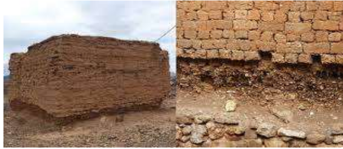
Figura 07. Erosión en muros de adobe.
