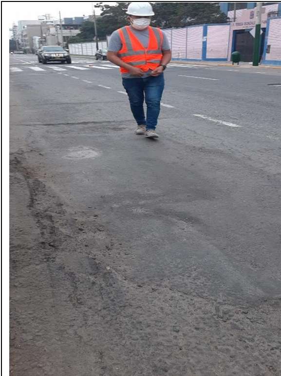
Figura 01: Fisuramiento en Borde Nivel de Severidad: Alta MU-02
