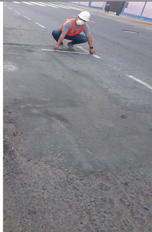
Figura 02: Fisuramiento en Bloque Nivel de Severidad: Alta MU-03
