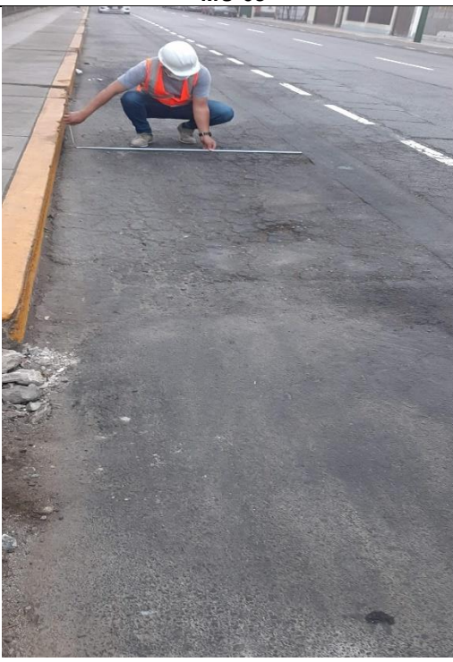
Figura 04: Hundimiento Nivel de Severidad: Alta MU-06
