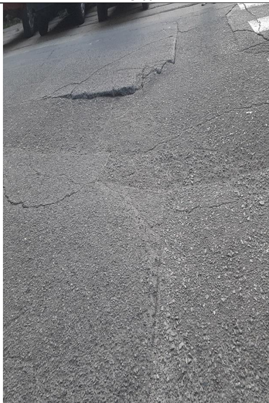
Figura 08: Hundimiento Nivel de Severidad: Alta MU-06
