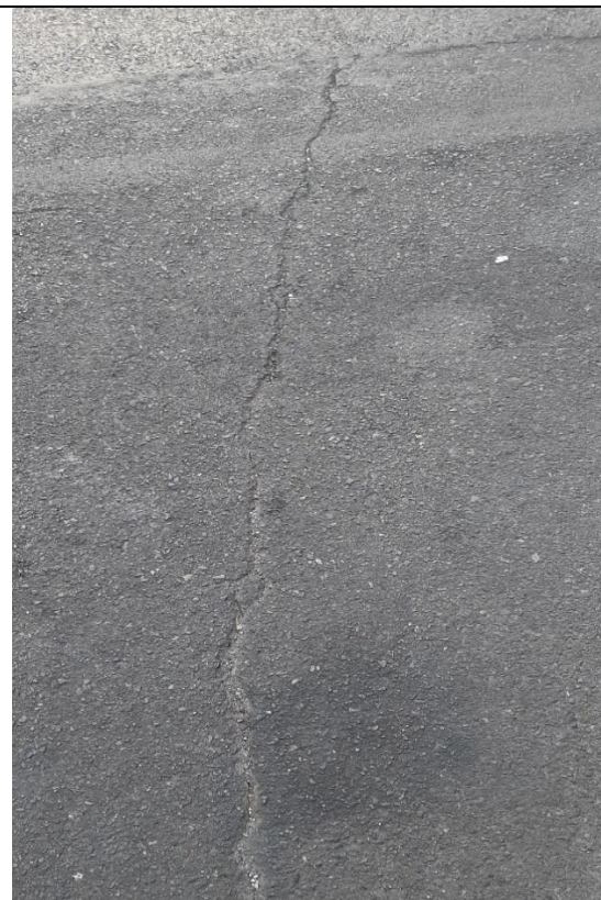
Figura 08: Fisuramiento parabólico Nivel de Severidad: Alta MU-012
