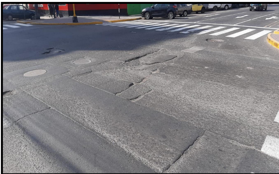
Fisuras en bloque
