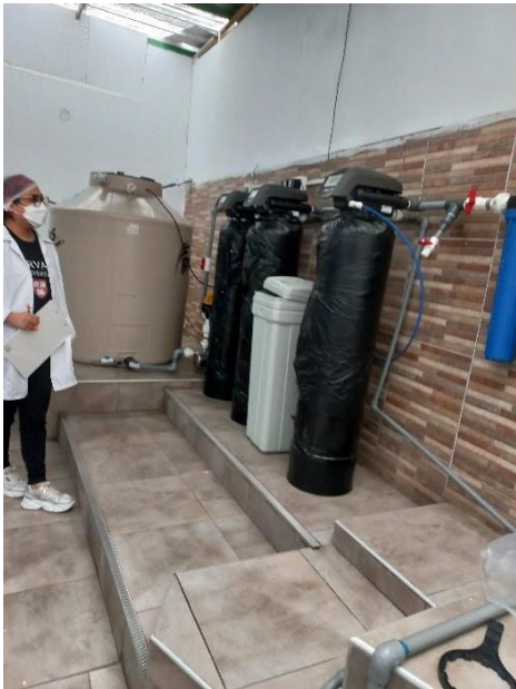
Foto 1 - Equipos del área de procesos
