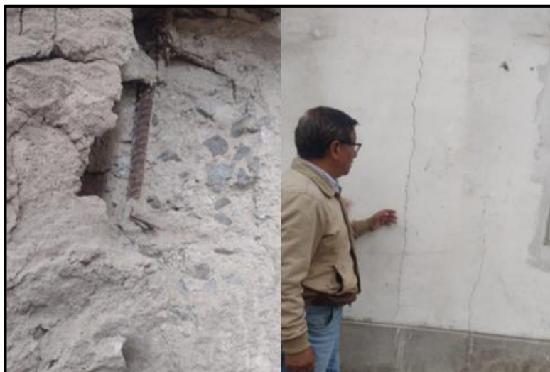
Figura 1. Fisuras y desprendimiento en el concreto
