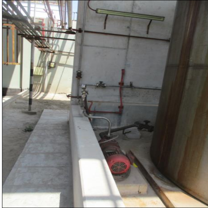
Figura 9. Ubicación de la bomba principal del sistema NAC SAC.
