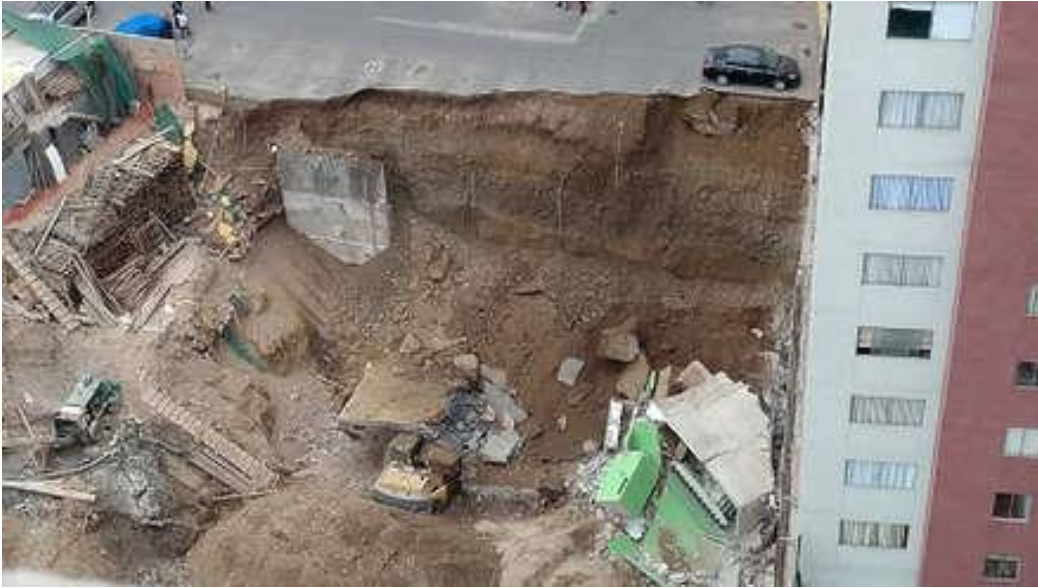
Figura 1. Derrumbe en obra de construcción afecta a estacionamiento.
