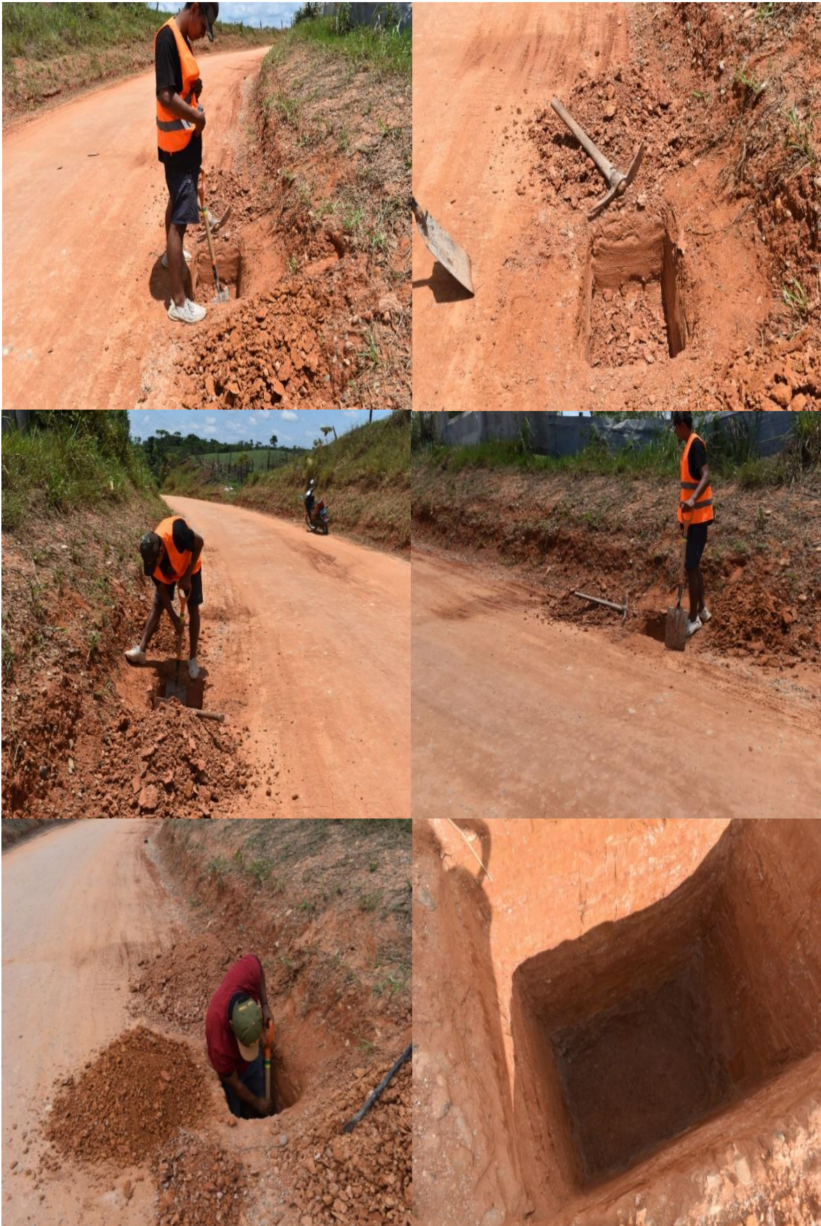
Figura 18. (a) Ejecución de calicatas y/o pozos de prueba para exploración de suelos
