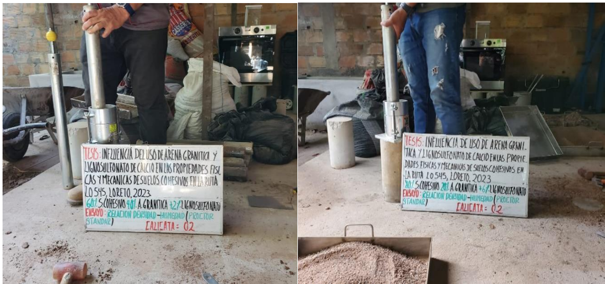
Figura 29. Compactación del espécimen con aproximadamente 25 golpes en 5 capas y pistón manual 10 libras.
