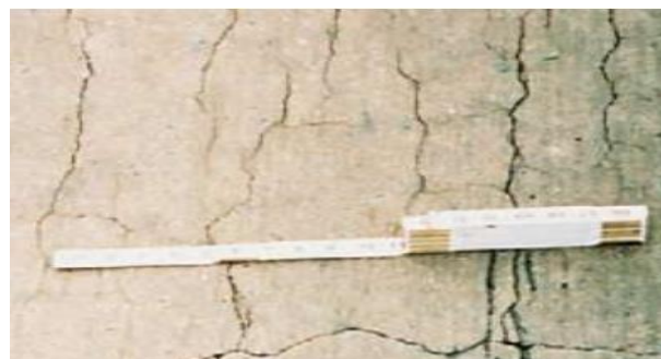
Figura 1. Agrietamiento en el concreto
