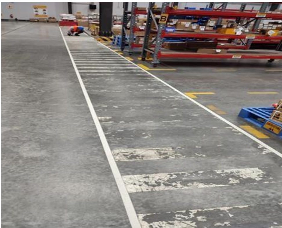
Figura 6. Piso sin señalización
