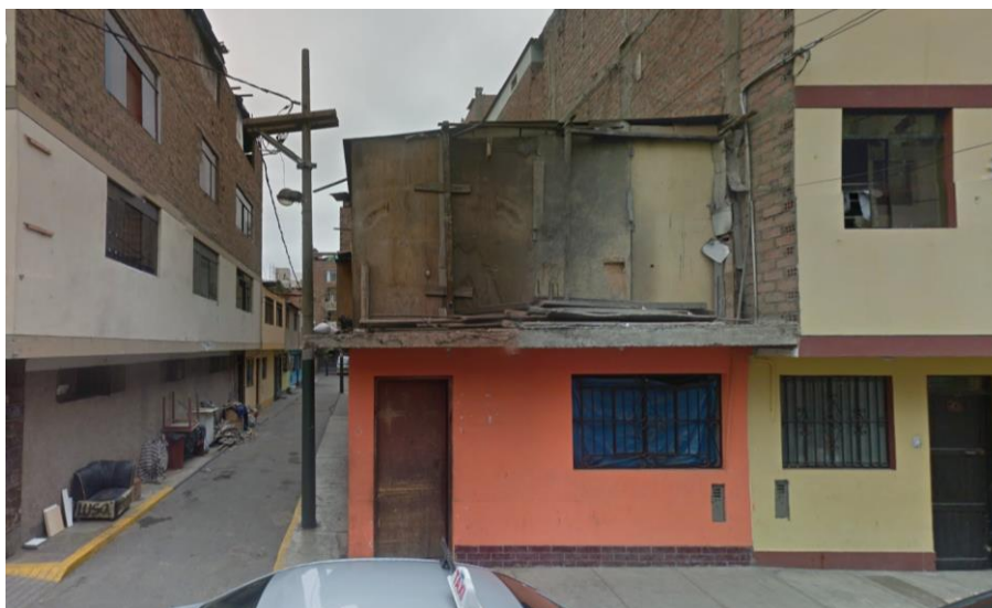
Fachadas en mal estado
