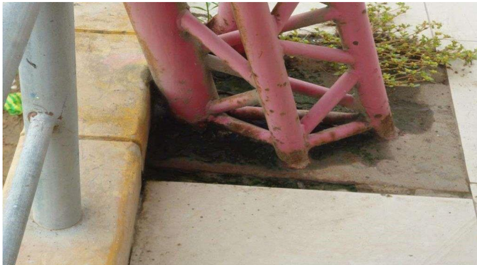
Figura 66. Estructura en mal estado del Malecón Tercer Milenio
