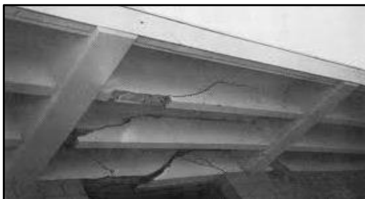
Figura 1. Fallas estructurales en vigas
