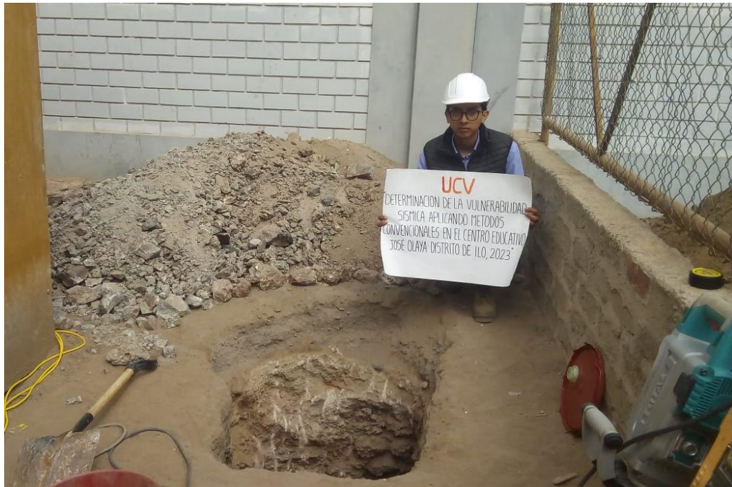
Se termina la excavación a los 2.50 m a causa que continuamente se sigue encontrando rocas que impiden el avance de la excavación.
