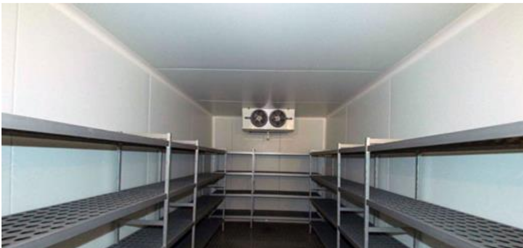
Figura 2. Parte interior de una Cámara frigorífica
