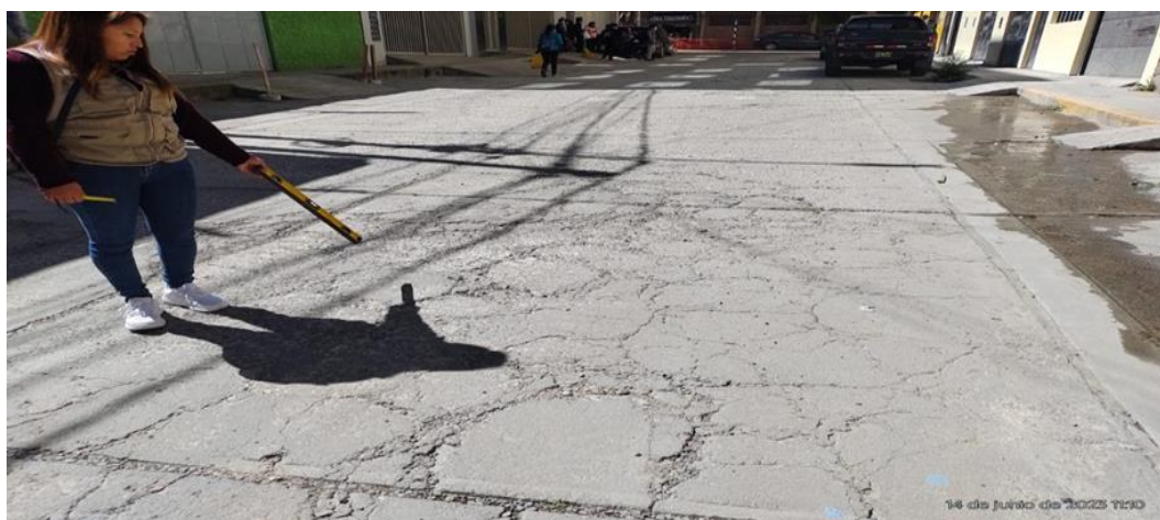
Figura 23: Falla de losa dividida
