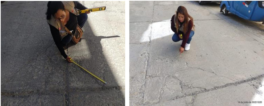
Figura 27: Falla de daño de sello de junta, fisuras transversales y roturas de esquina.
