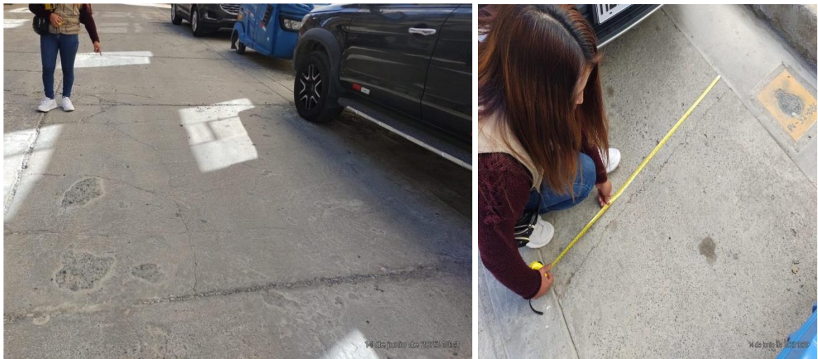
Figura 32: Falla de grieta lineal.
