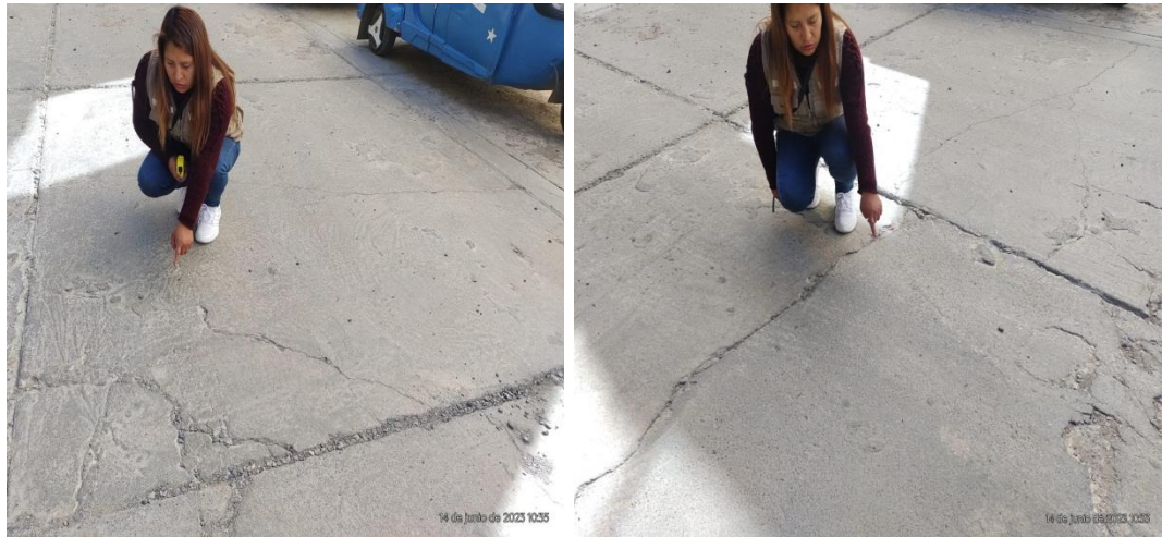
Figura 24: Falla de grieta de durabilidad
