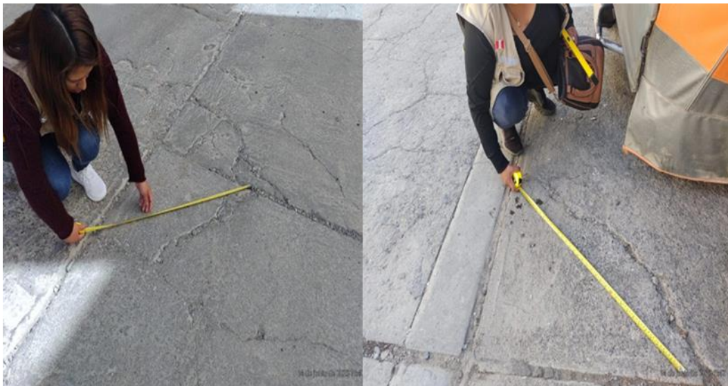
Figura 22: Falla de la grieta de esquina
