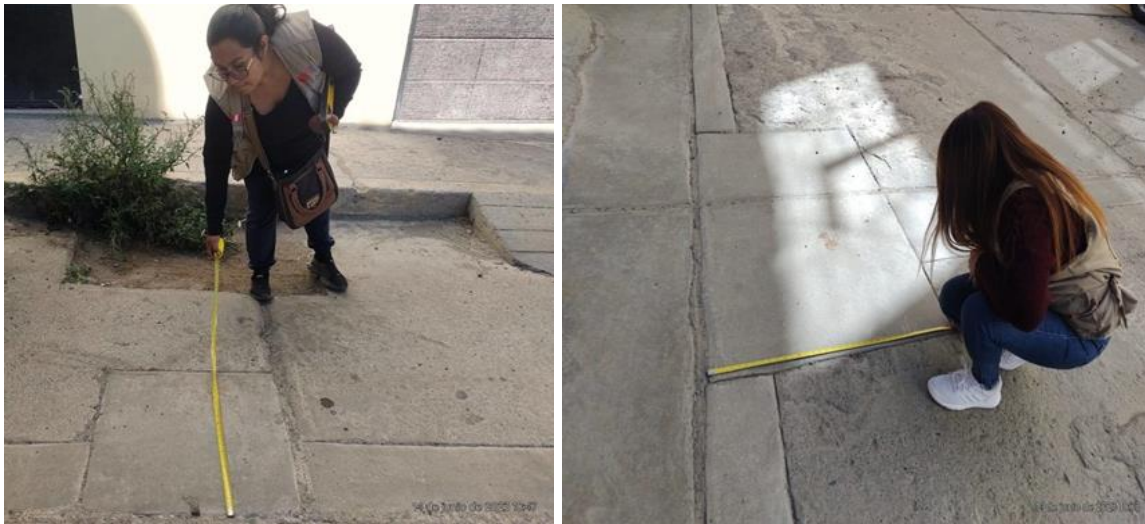
Figura 30: Falla de parche grande, acometidas, de servicio público y pulimiento de agregados
