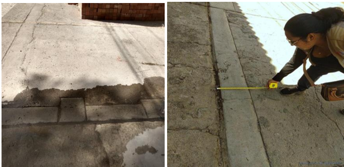
Figura 29: Falla de grietas transversales, fisuras longitudinales y transversales
