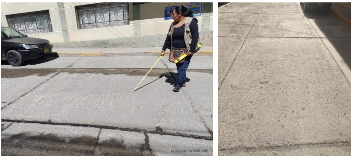
Figura 31: Falla de pulimiento de agregados
