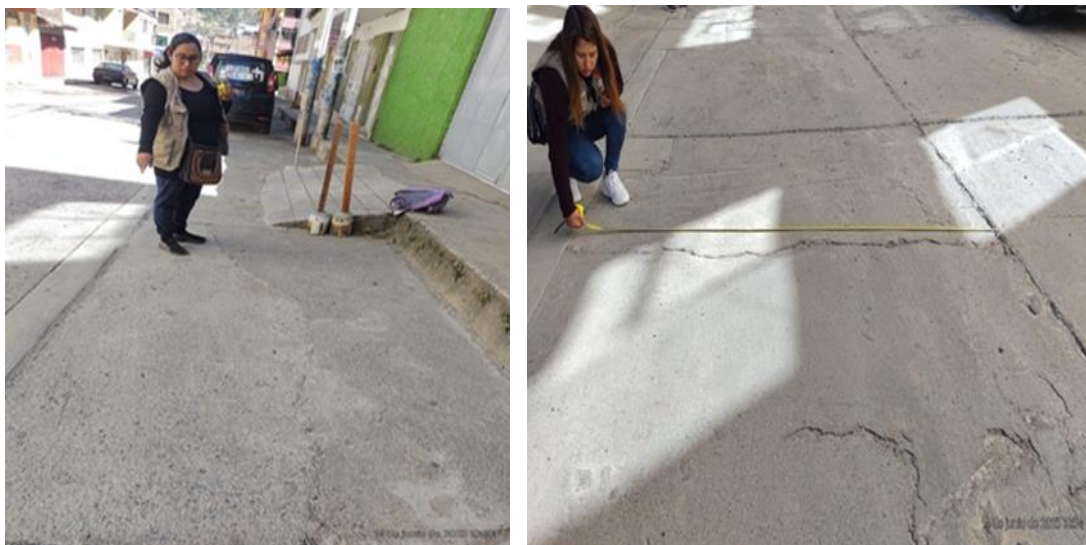
Figura 28: Falla de grietas longitudinales, fisura transversal y parche pequeño.
