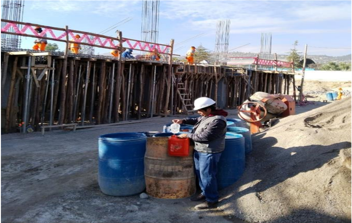
Descripción: Se observa la recolección del agua con oxido para su análisis.
