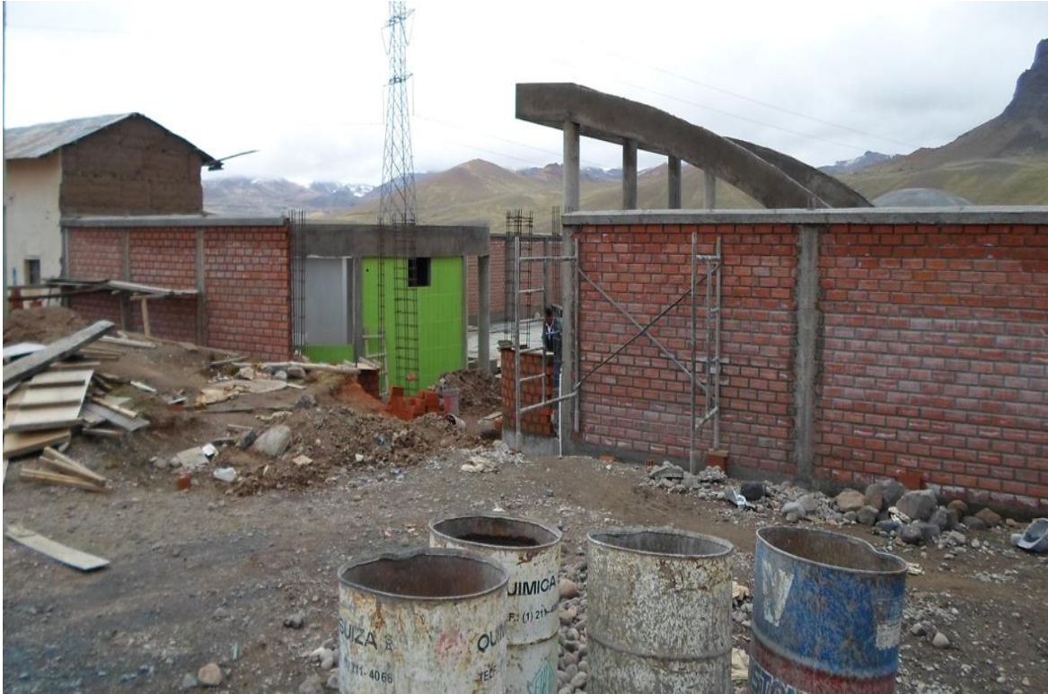
Descripción: Se observa los cilindros metálicos con presencia de óxido de hierro
