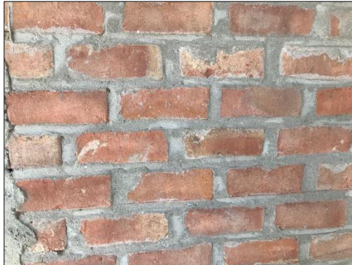
Figura 4: Junta de mortero mayores a 2.5 cm
