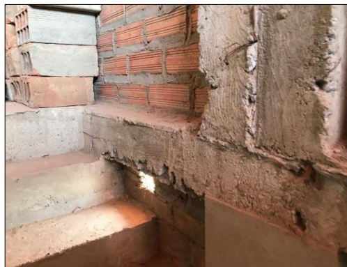
Figura 5: Cangrejas en los elementos estructurales
