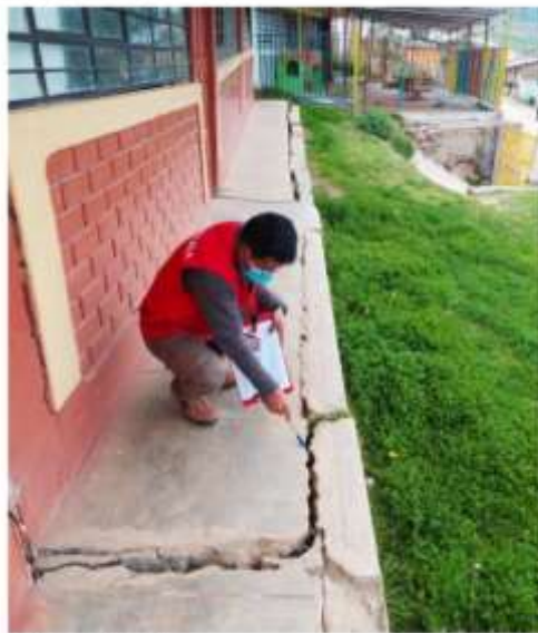
Craqueo en la estructura
