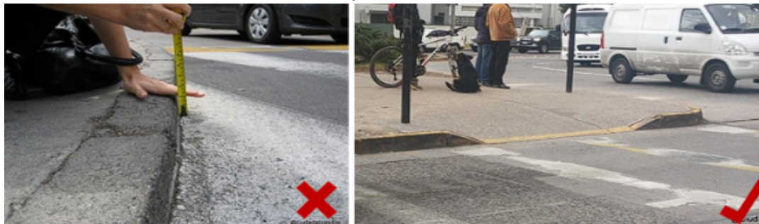
Ciudadaccessible.cl - Desnivel de piso
