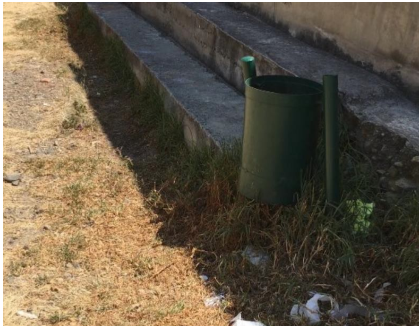
Figura 31. Falta de mantenimiento y limpieza del campo deportivo
