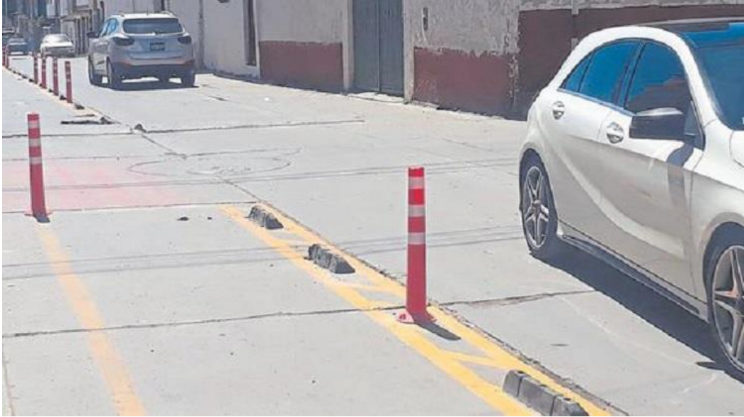
Figura 26. Ciclovías en mal estado
