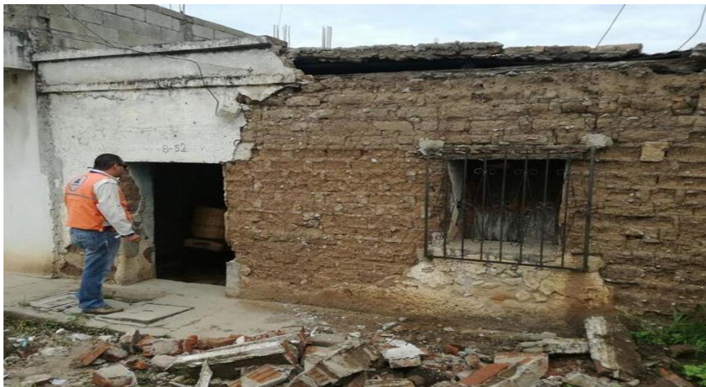
Figura 1. Vivienda con Combinación de materiales incompatibles.
