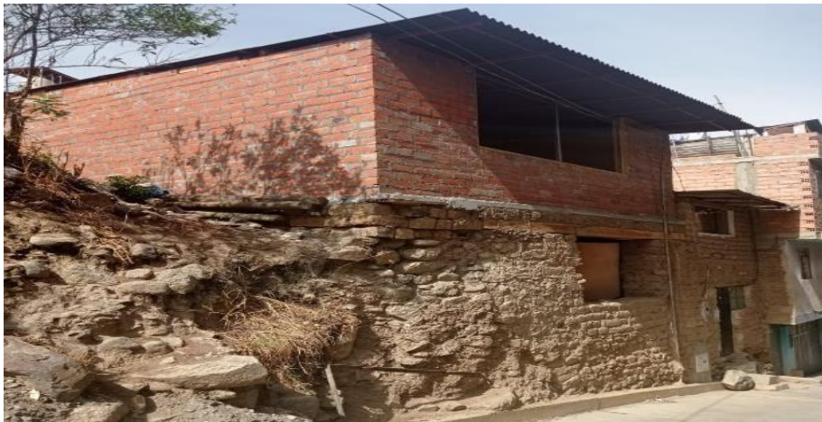
Figura 4. estado físico de las viviendas con usos de combinación de materiales.
