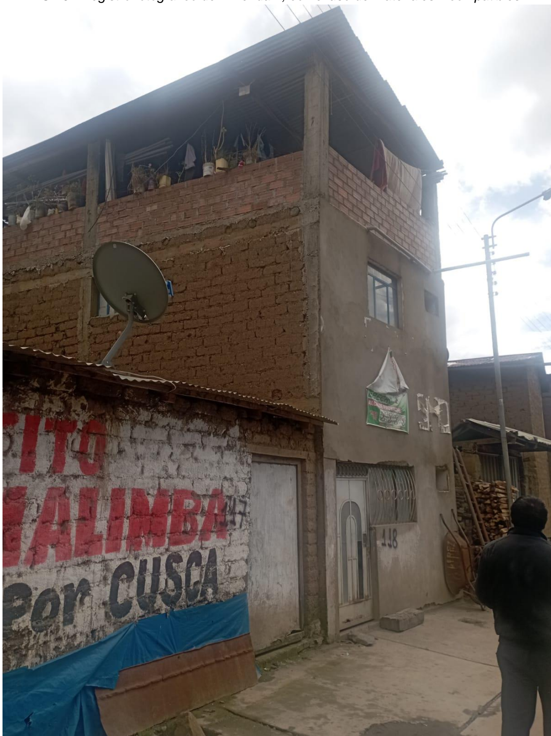
ANEXO 19. Registro fotográfico de Vivienda 2, con el uso de materiales incompatibles.
