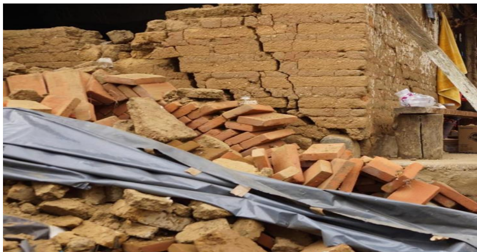
Figura 2. Vivienda con Combinación de materiales incompatibles.
