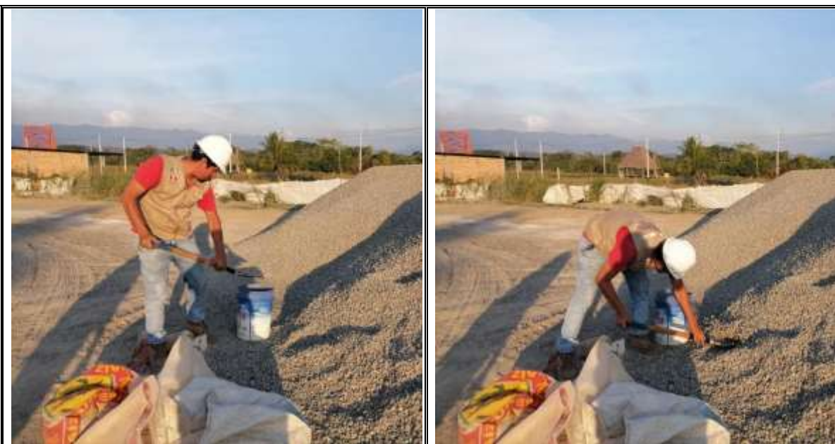
Fotos N° 01-02: En las imágenes se puede apreciar el muestreo de la grava chancada.
