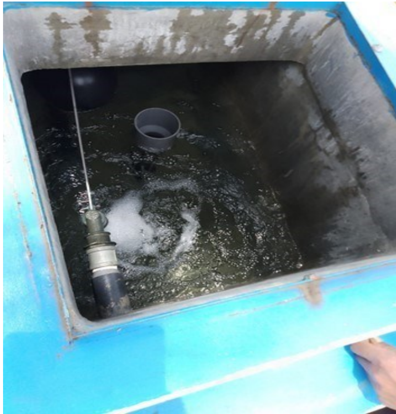
Zona de distribución en sistema de agua potable
