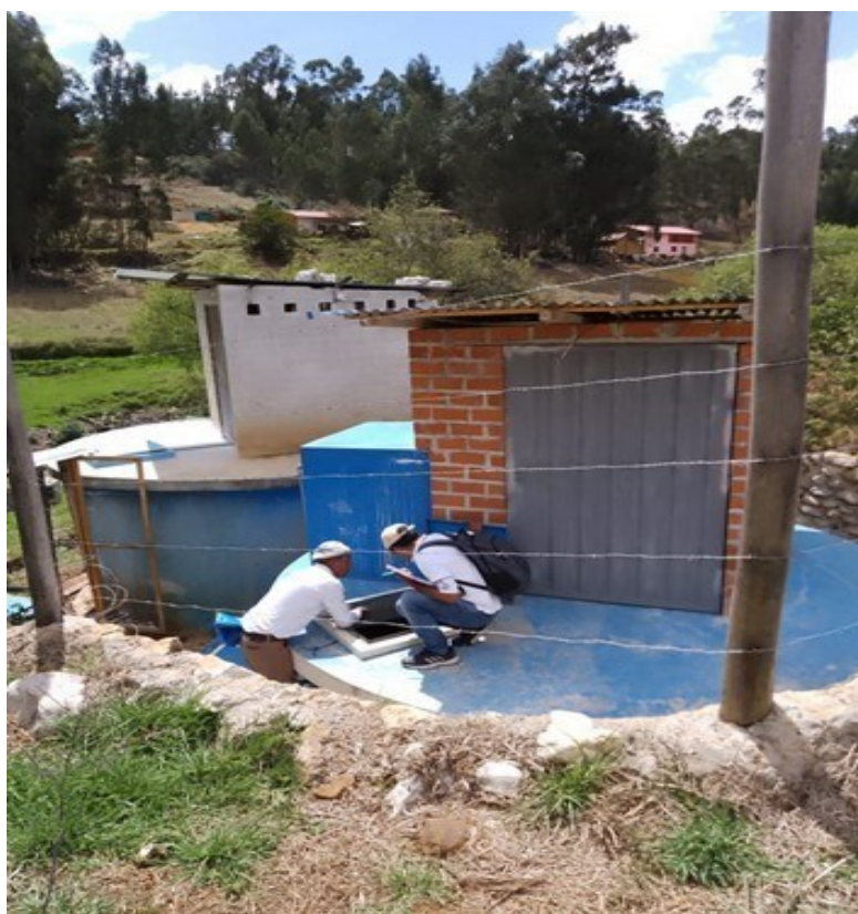
Reservorio del sistema de agua potable
