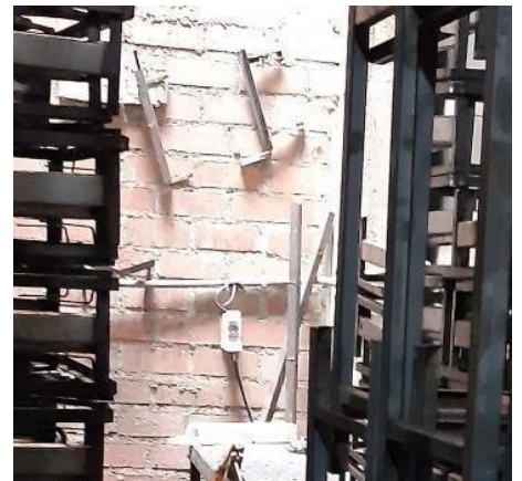
Ilustración 4: Falta de señalización de riesgo eléctrico
