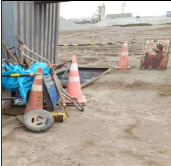
Figura 15. Falta de señalización.
