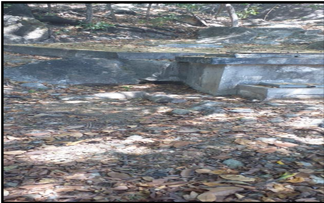
DESCRIPCIÓN: Captación “Gorgoncillo Bajo” Del Centro Poblado De Chirinos.
