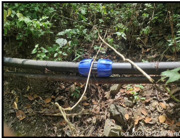
DESCRIPCIÓN: Línea de conducción
