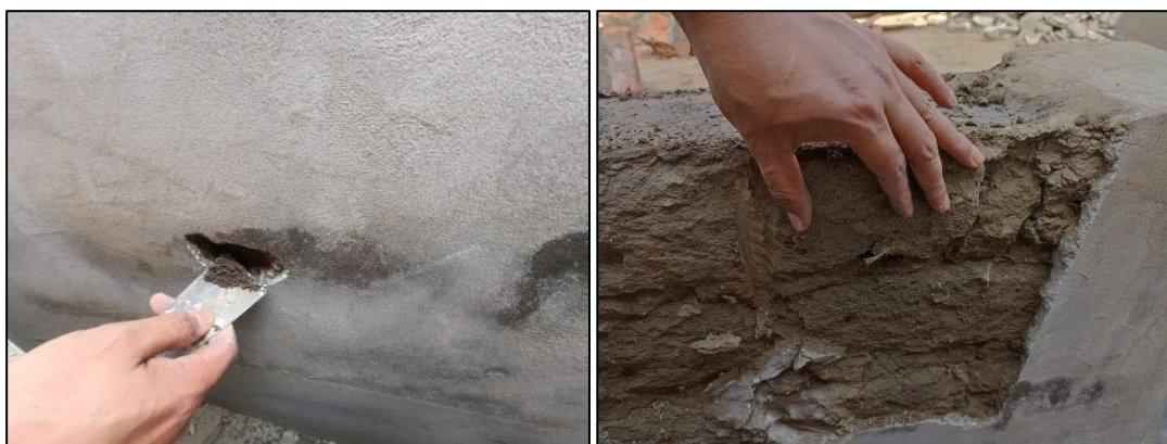
Figura 23 Filtración de agua en el sobrecimiento tarrajado
