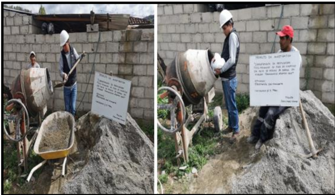
Preparación de mezcla de concreto F'c=175\text{kg}/\text{cm}^2 con la adición del polvillo de residuo de mármol según los indicadores: al 4% PRM, 5%PRM y 6% PRM.
