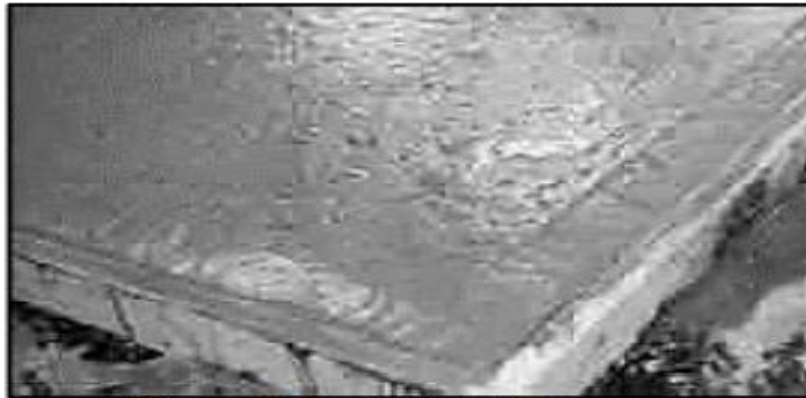
Figura 4: Exudación del concreto.
