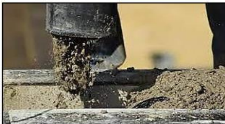
Figura 3. Segregación del concreto.
