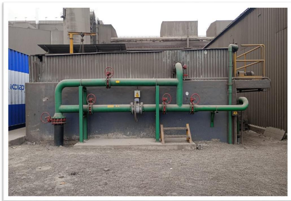
Línea de entrada de agua de pozos
