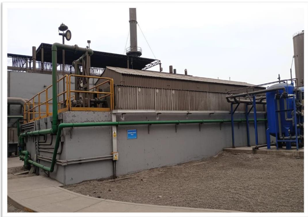
Línea de entrada de agua de pozos
