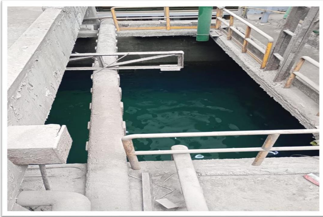
Reservorio auxiliar de agua de rechazo
