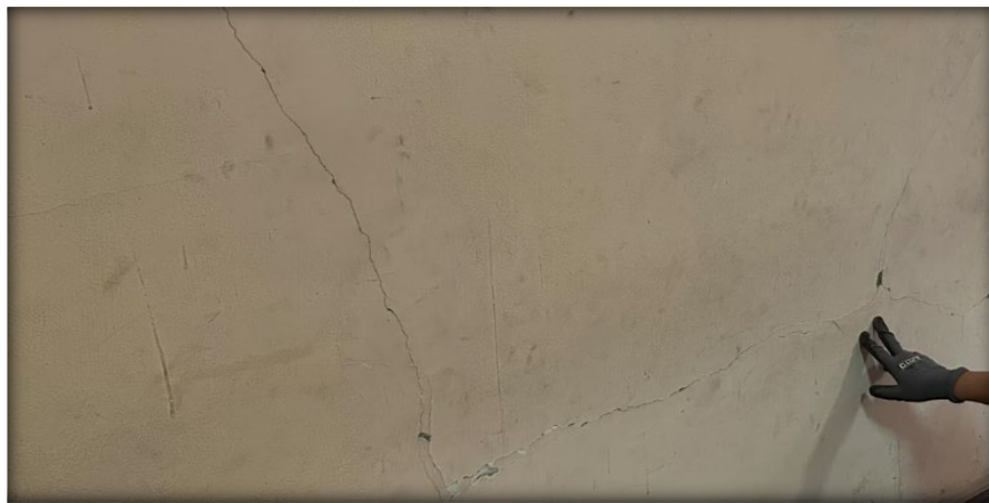
Figura 32: Fisuras y grietas horizontales en muros. Fuente: Propia.
