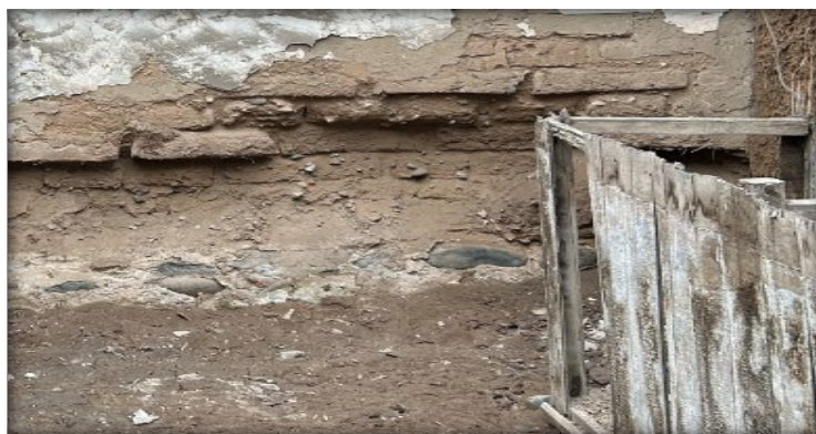
Figura 42: Degradación de muros. Fuente: Propia.
