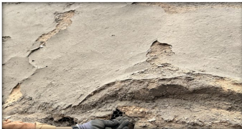
Figura 39: Pérdida parcial de cobertura. Fuente: Propia.
