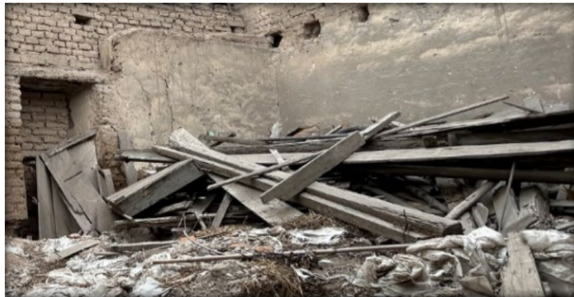
Figuras 57: Grietas en muros y colapso de techos. Fuente: Propia.
