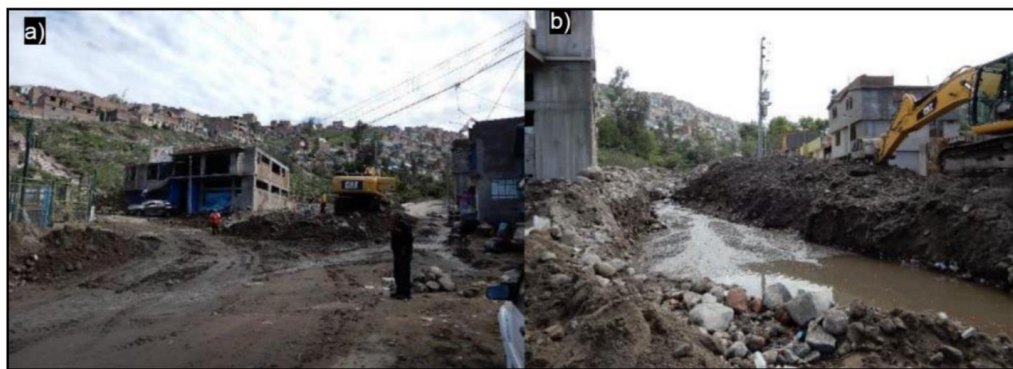
Figura 11. Inundación en puente Pozo Negro.
