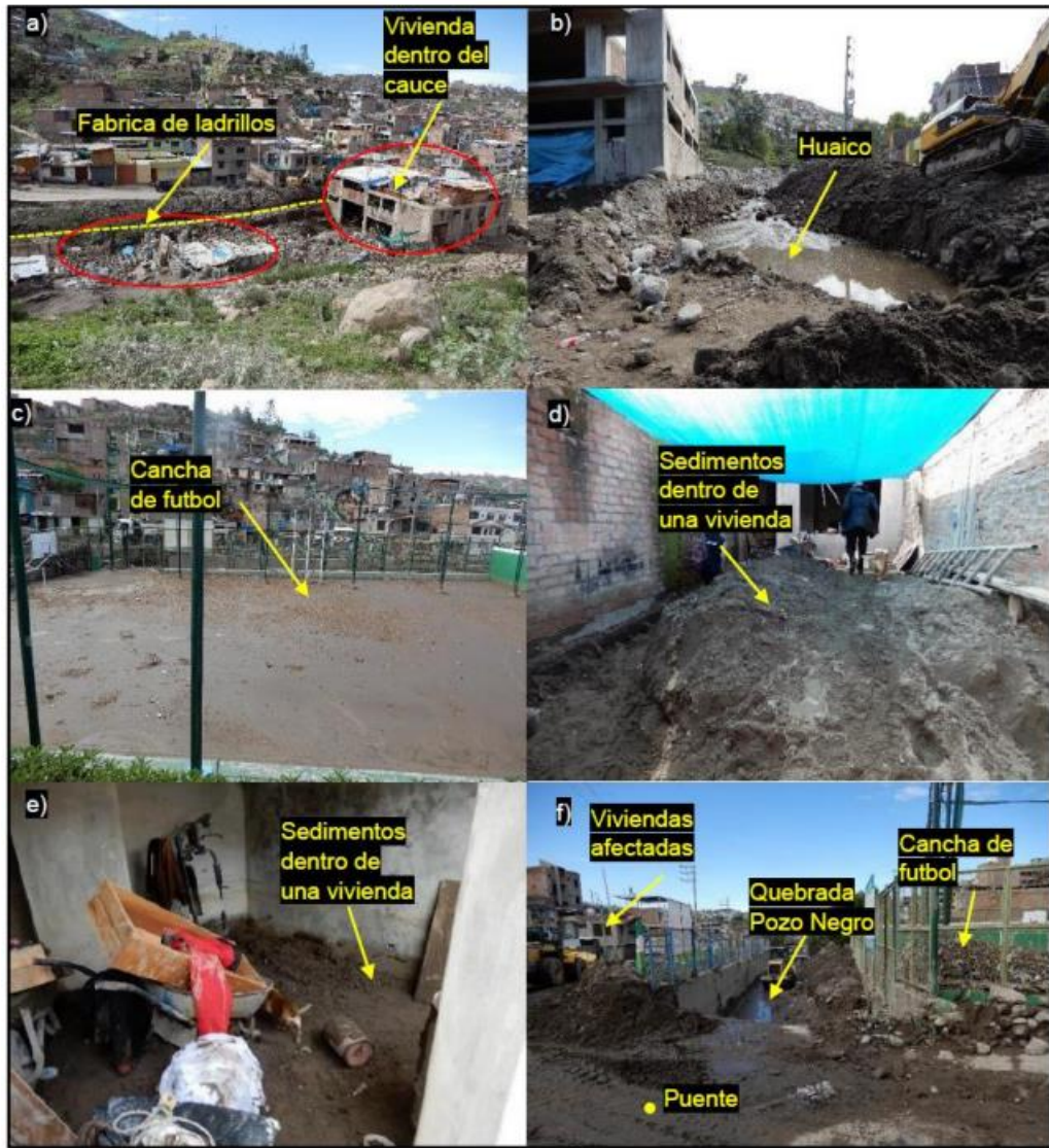
Figura 12. Huaico afectación en estructuras.
