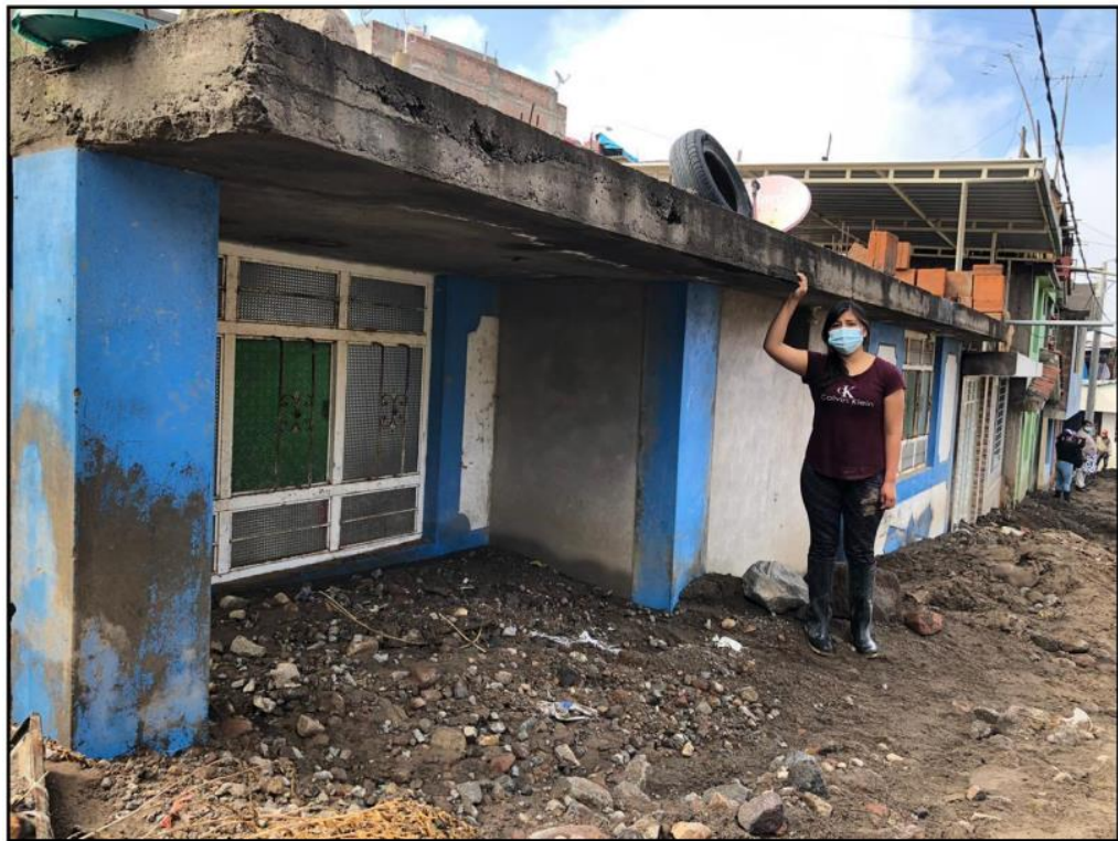
Figura 14. Ejemplo de inundación en vivienda.
