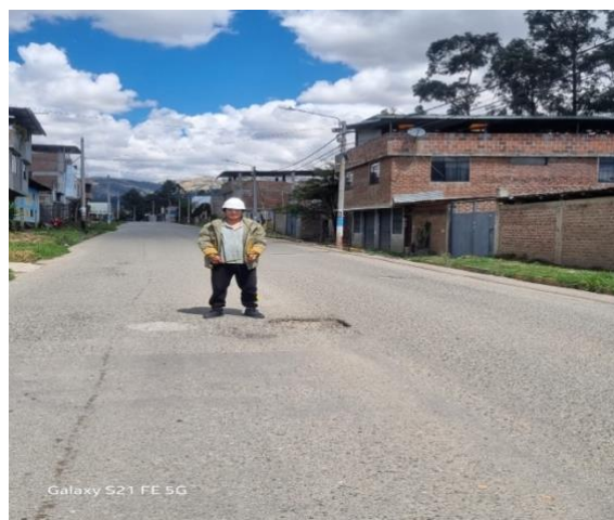
Figura 1. Bache con área de 66cm x 66cm y profundidad de 8mm en la av. Confraternidad km 1+060
