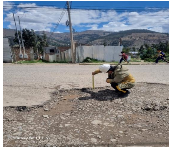
Figura 2. Desprendimiento de la capa de rodadura y presencia de humedad en la av. Confraternidad km 0.750
