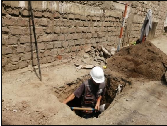
Panel fotográfico N° 1: Inicio de la excavación de la calicata N°1 de la calle Buenos Aires.
