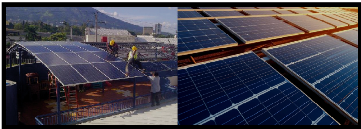
GRÁFICO 3: Uso de paneles solares en coberturas
