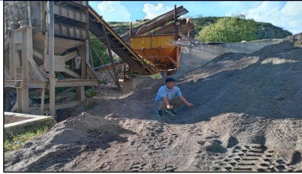
Ilustración 18. FOTOS DE VISITA IN-SITU, MAQUINAS DE SARANDEO
