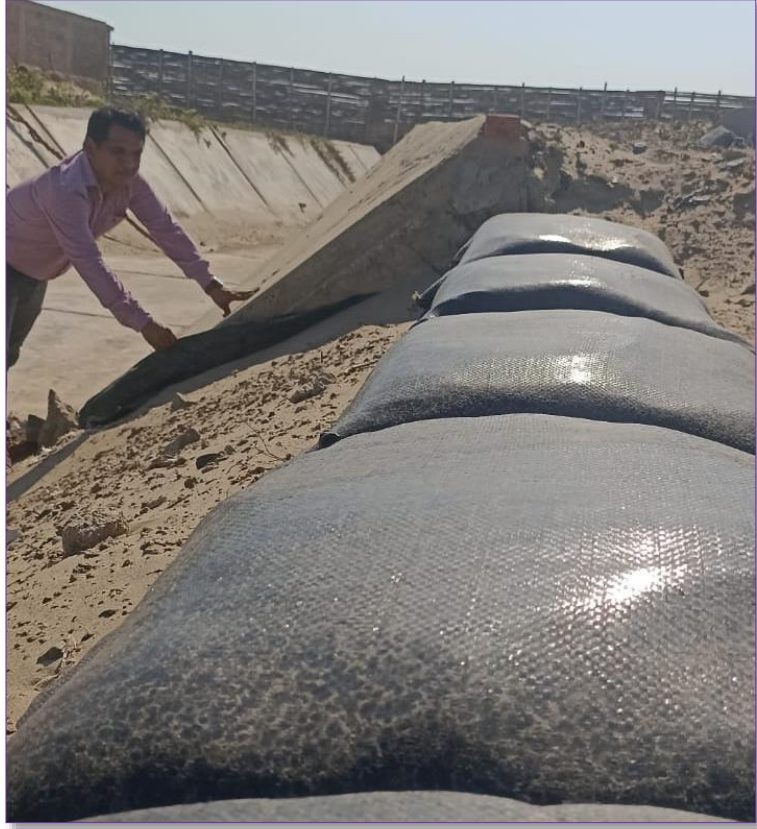
Imagen 12: canal de concreto mal construido
