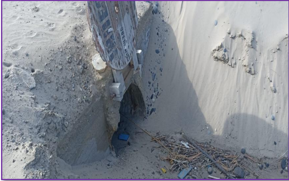
Imagen 14: compuerta de madera en total deterioro la cual no cumple su función.
