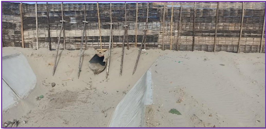
Imagen 15: tubería metálica de alcantarilla en mal estado y a nivel más alto que el canal.
