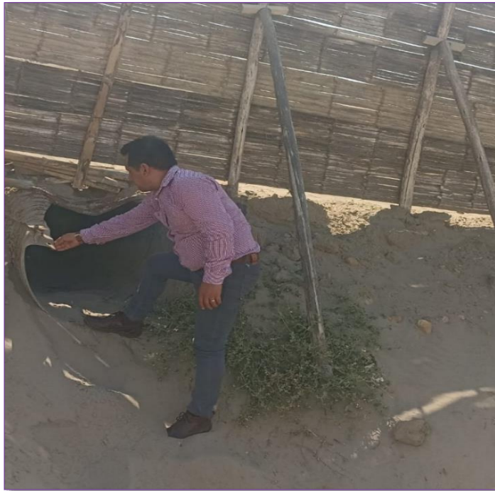
Imagen 13: tubería metálica la cual sirve de drenaje de las aguas pluviales se encuentra en mal estado.
