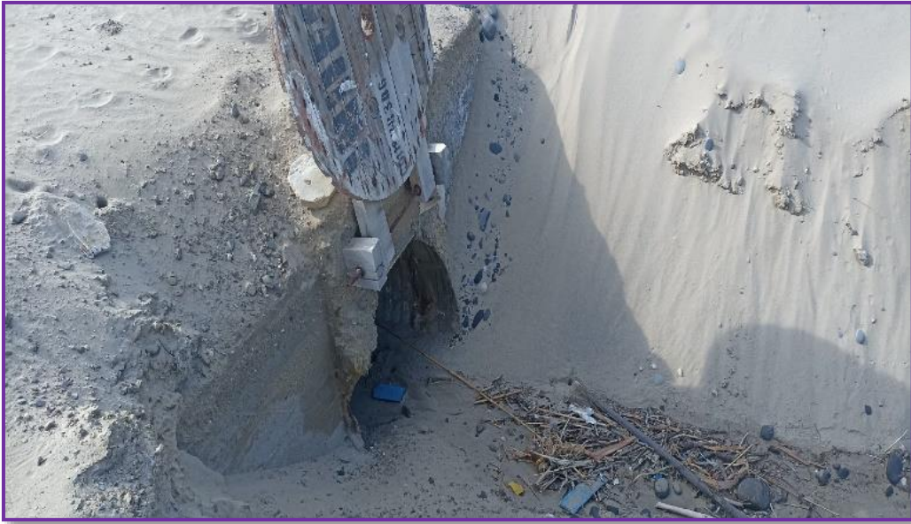
Imagen 16: desembocadura de tubería metálica de alcantarilla en mal estado
