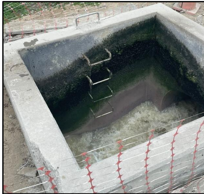
FIGURA 4. Aguas residuales de PTAR
