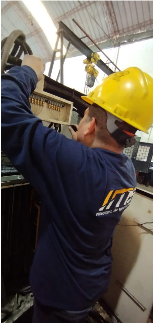
(b) Mantenimiento a los dosificadores de la maquina Nakamura
