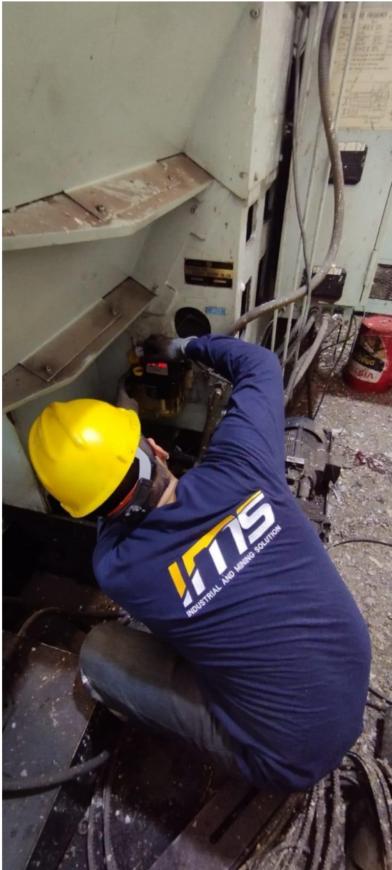
(a) Mantenimiento al tanque de lubricación de la maquina Kasuga
