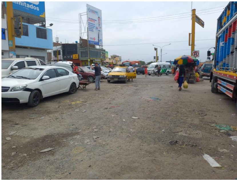
Figura 17: Estado actual de las pistas frente al mercado. (Av. Federico Villarreal)
