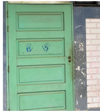
Figura: 02 estado actual Puertas
