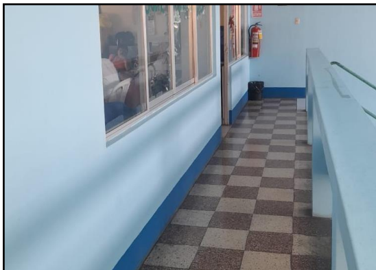
Figura 9: Estado actual de los pisos del segundo nivel
