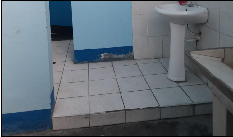
Figura 5: Ampollamiento de pinturas en paredes del bloque de SS-.HH en el CAM EsSalud
