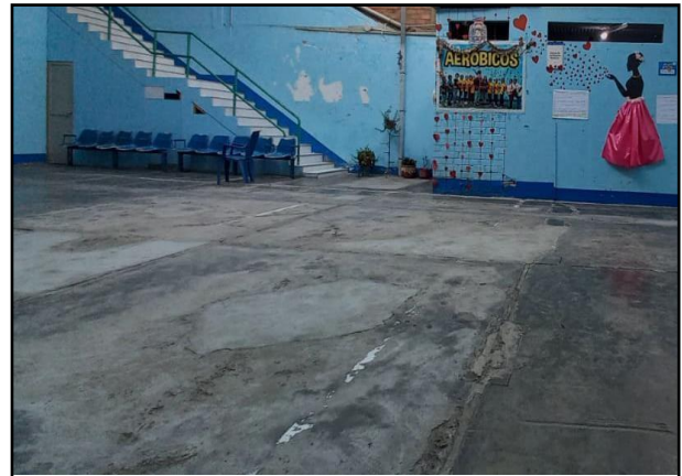
Figura 8: Estado actual del piso en el patio
