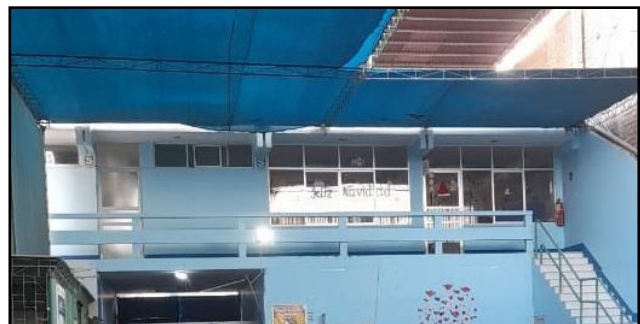
Figura 4: Estado actual del bloque administrativo del CAM-EsSalud
