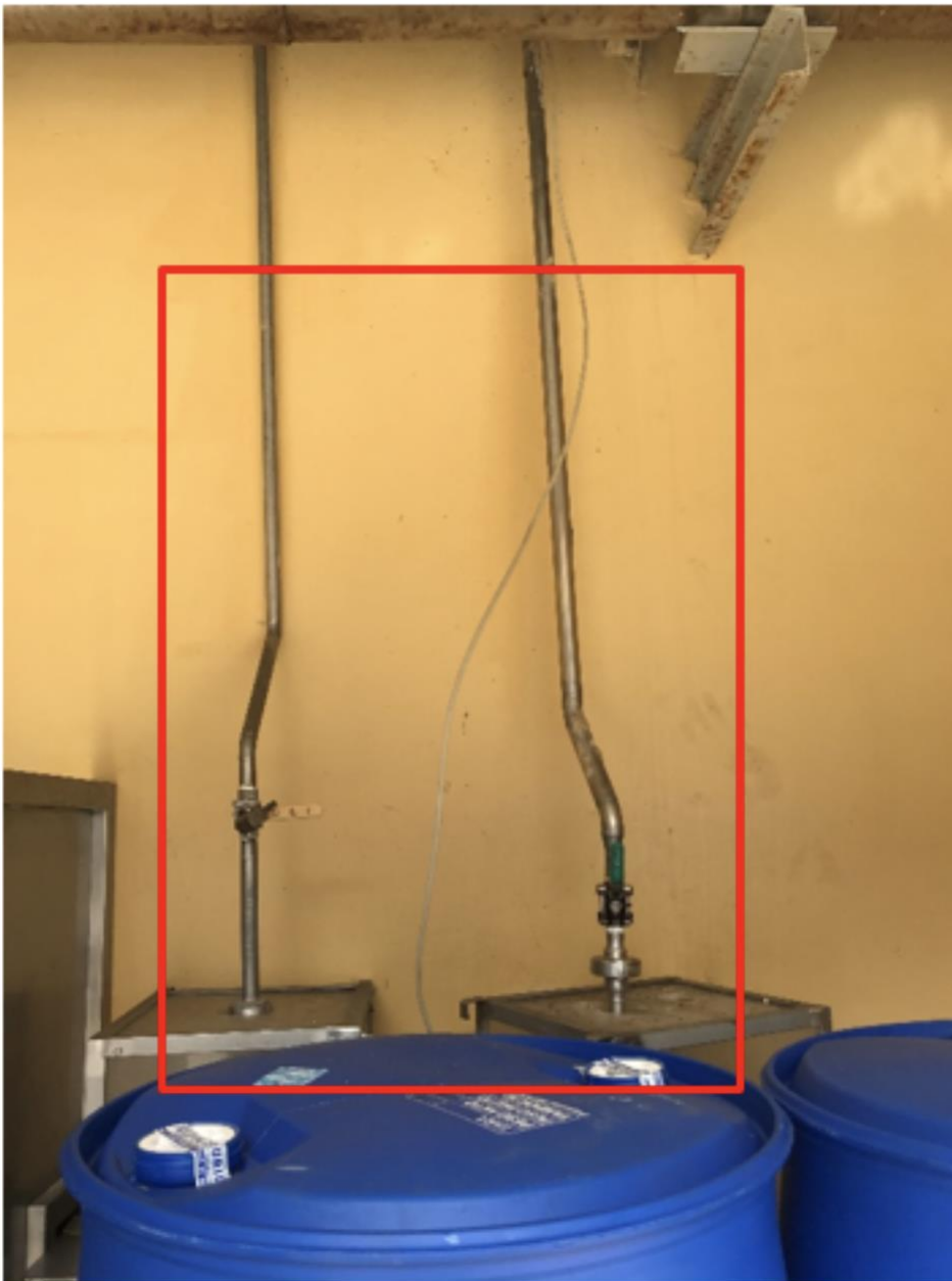
Imagen 6.3, líneas de dosificación de estación de químicos
