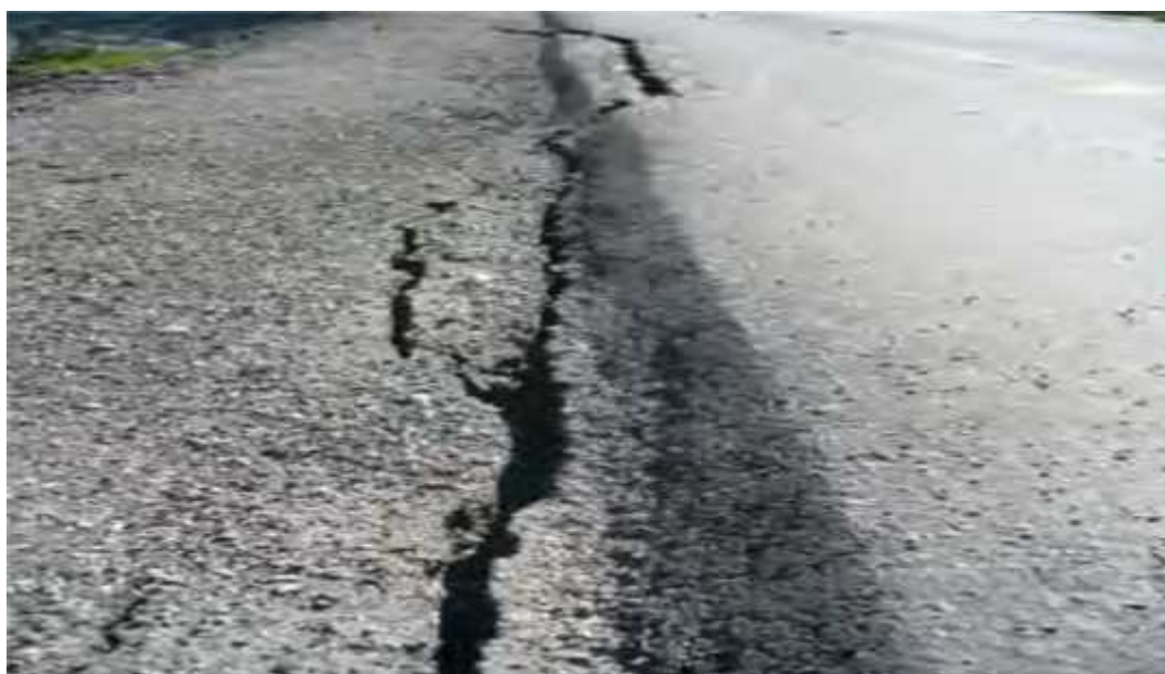
Figura 3. Agrietamiento en el borde de la berma y del talud inferior Km. 115+750, Tomado de Núñez (2014)
