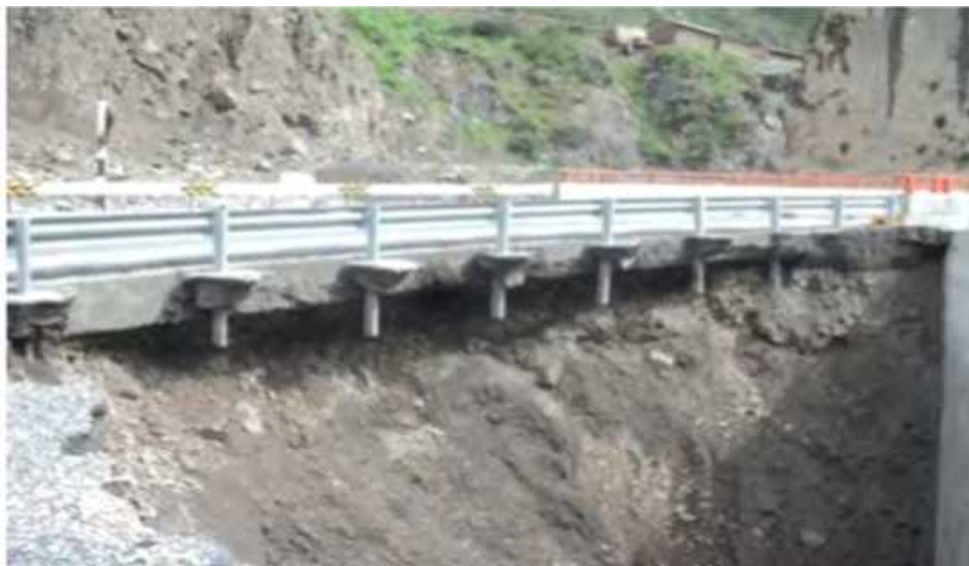
Figura 6. Falla del enrocado por socavación, haciendo que los bloques rocosos se desplomen hacia el cauce, produciendo el colapso parcial del terraplén. Tomado de Núñez (2014)
