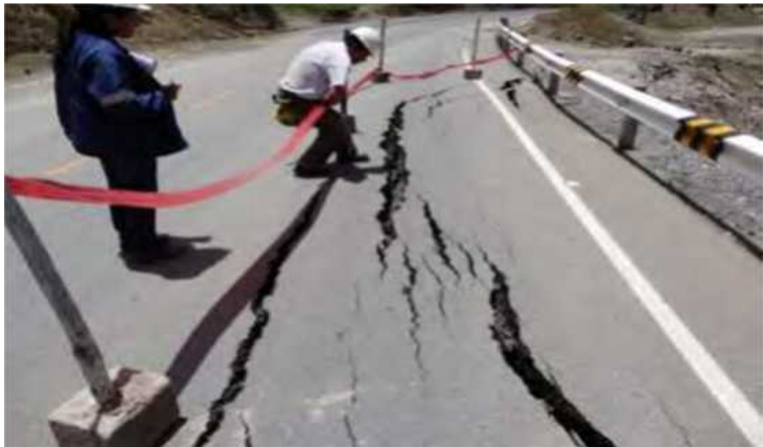
Figura 5. Agrietamiento en la calzada – Km. 130+400, Tomado de Núñez (2014)
