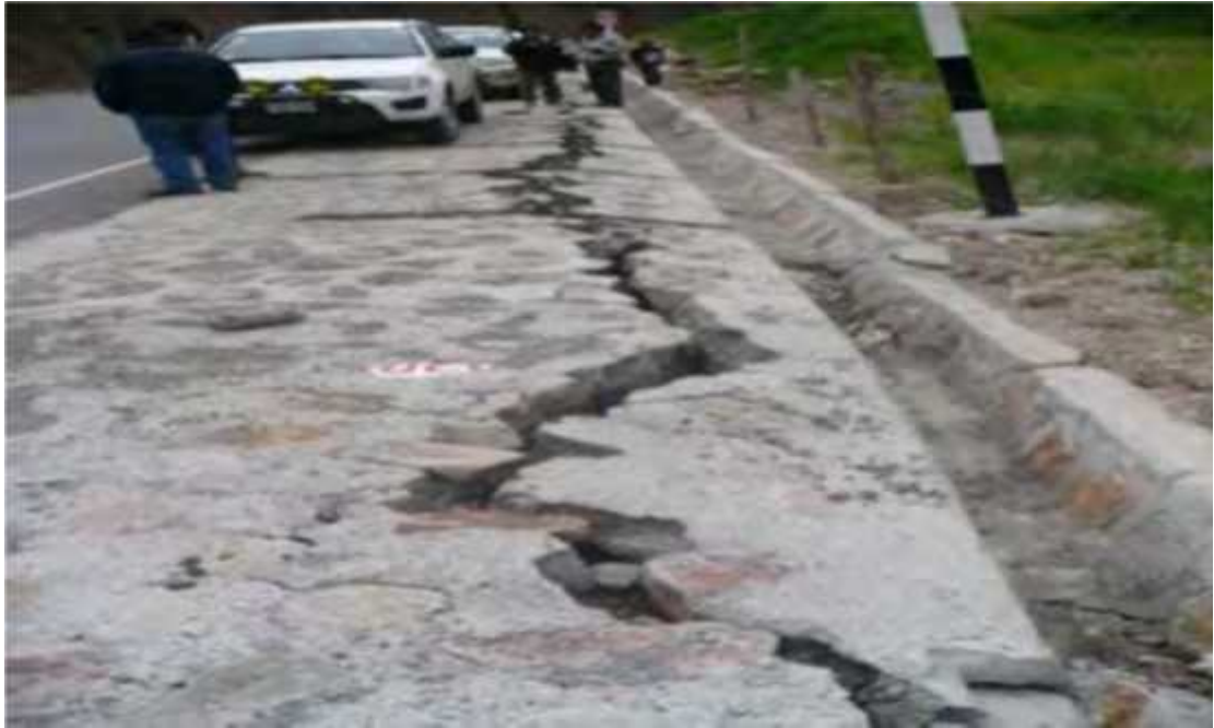
Figura 4. Agrietamiento en berma y cuneta – Km. 124+450 Tomado de Núñez (2014)
