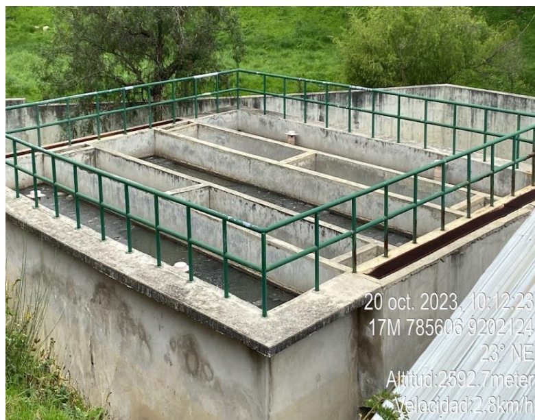
Figura 7 Estado actual del desarenador Ptar Llacanora
