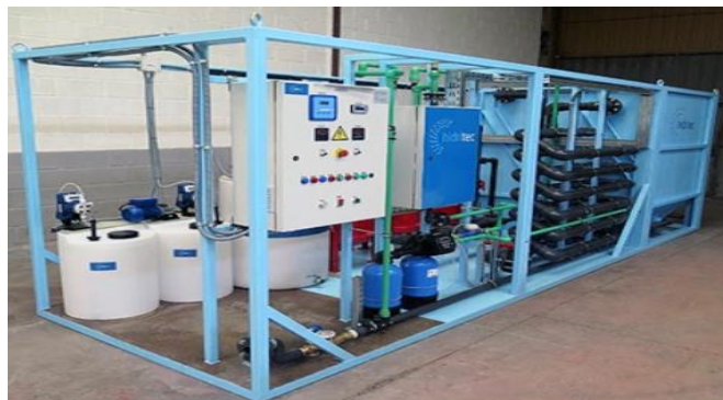
Figura 9 Cámara de cloración
