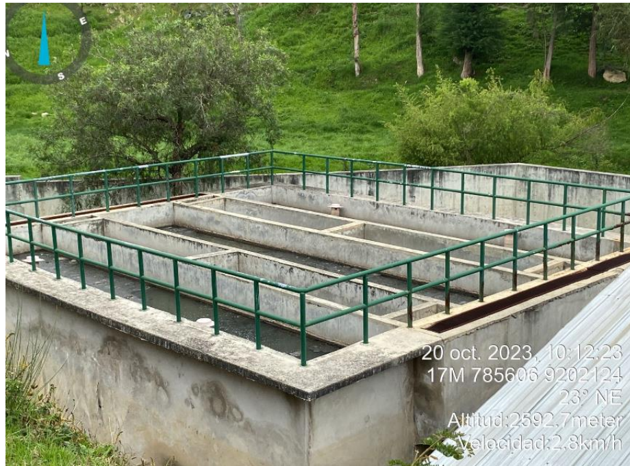
Figura 4 Estado actual de la PTAR en el distrito de Llacanora
