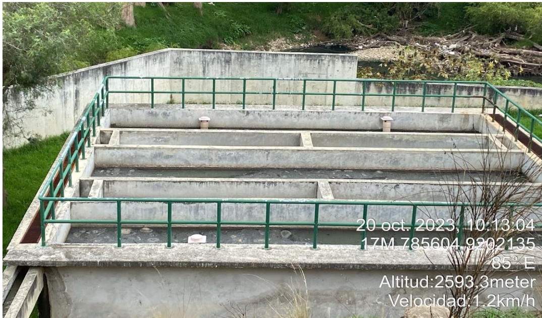
Figura 5 Imagen del mal estado de las rejas que cercan la Ptar
